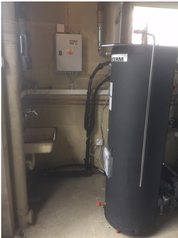
Kuva 4. Puskurivaraaja ja kuumakaasuputket.
