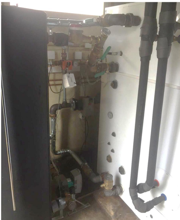
Kuva 5. Hybridivaraajan kytkentä vasemmalla olevaan puskurivaraajaan.
