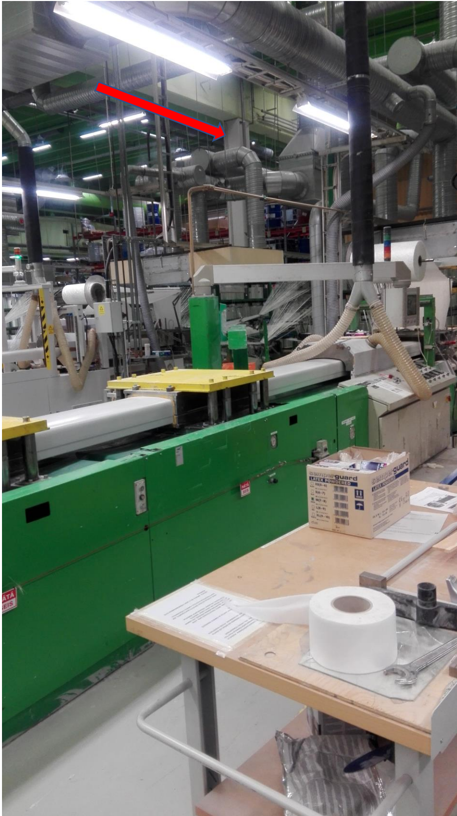
Kuva 43. Ilmanvaihtokanavat peittävät näköyhteyden nuolen osoittamassa pylväessä olevaan paloturvallisuusopasteeseen, joka osoittaa palosammuttimen paikan sitä tarvittaessa.
