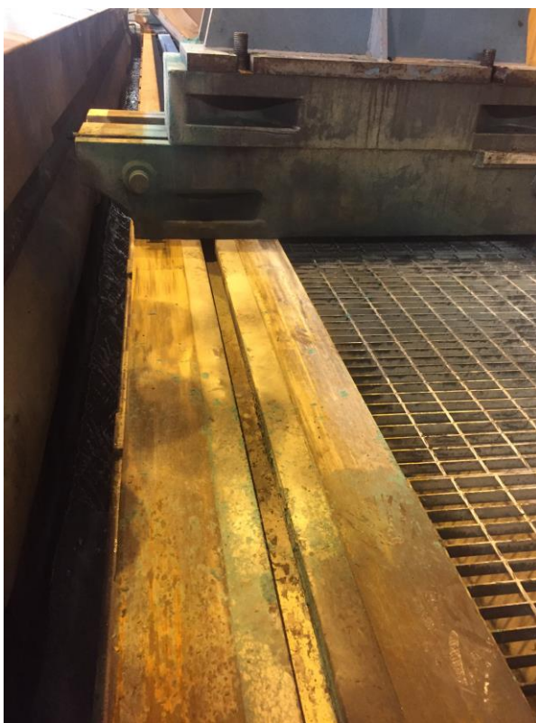
Kuva 17. Tukipyökkien johteiden ruostuminen.
