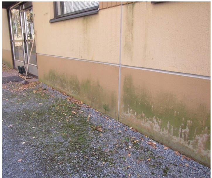
Kuva 8. Pesetyynyttä ja irronnutta maalipintaa (talo 2).
