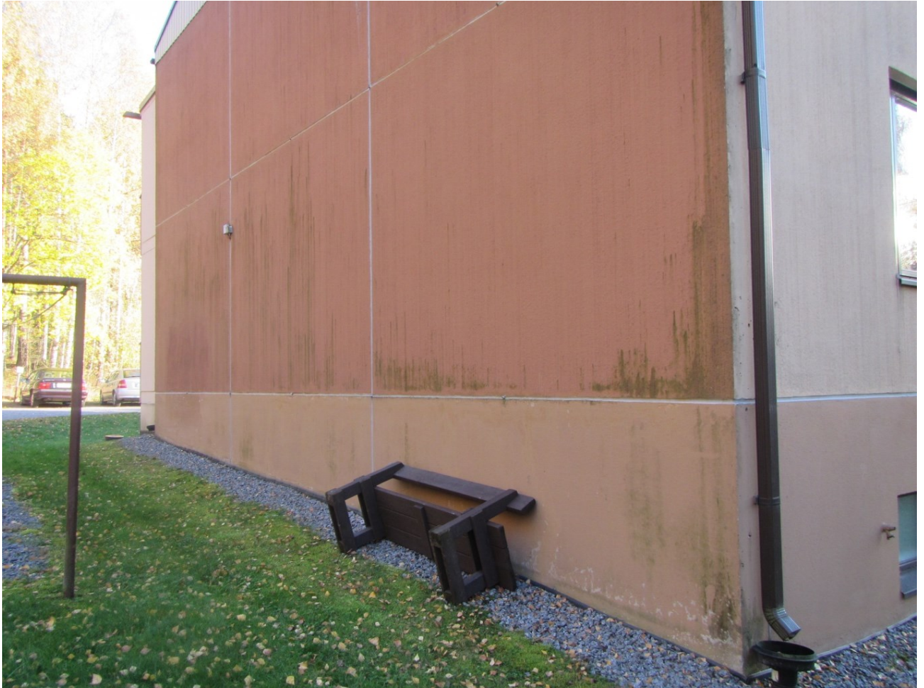
Kuva 9. Julkisivupinnat ovat huomattavan likaantuneet metsän puolelta taloissa 2 ja 3 (kuva talosta 3).
