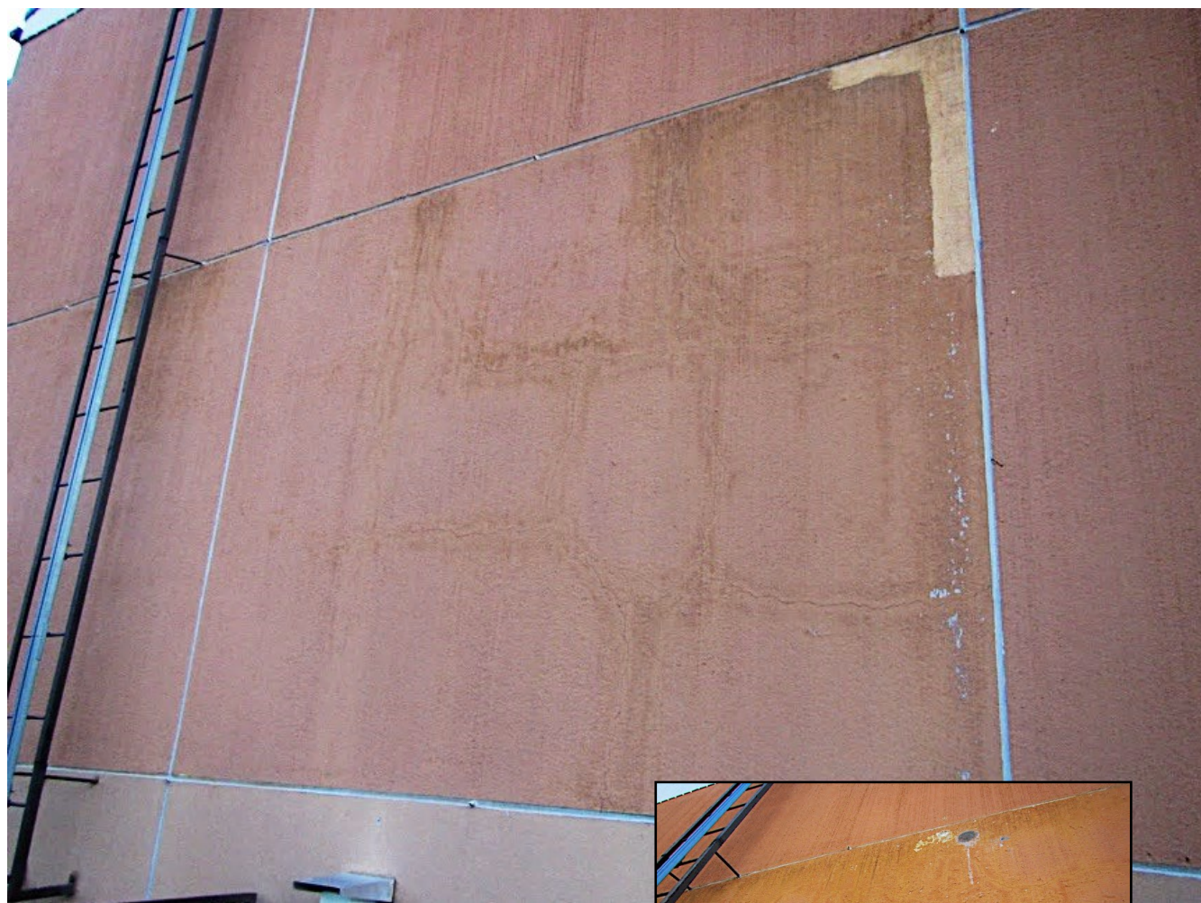
Kuva 1. Julkisivujen päätyelementeissä havaittuja pinnan halkeamia.
