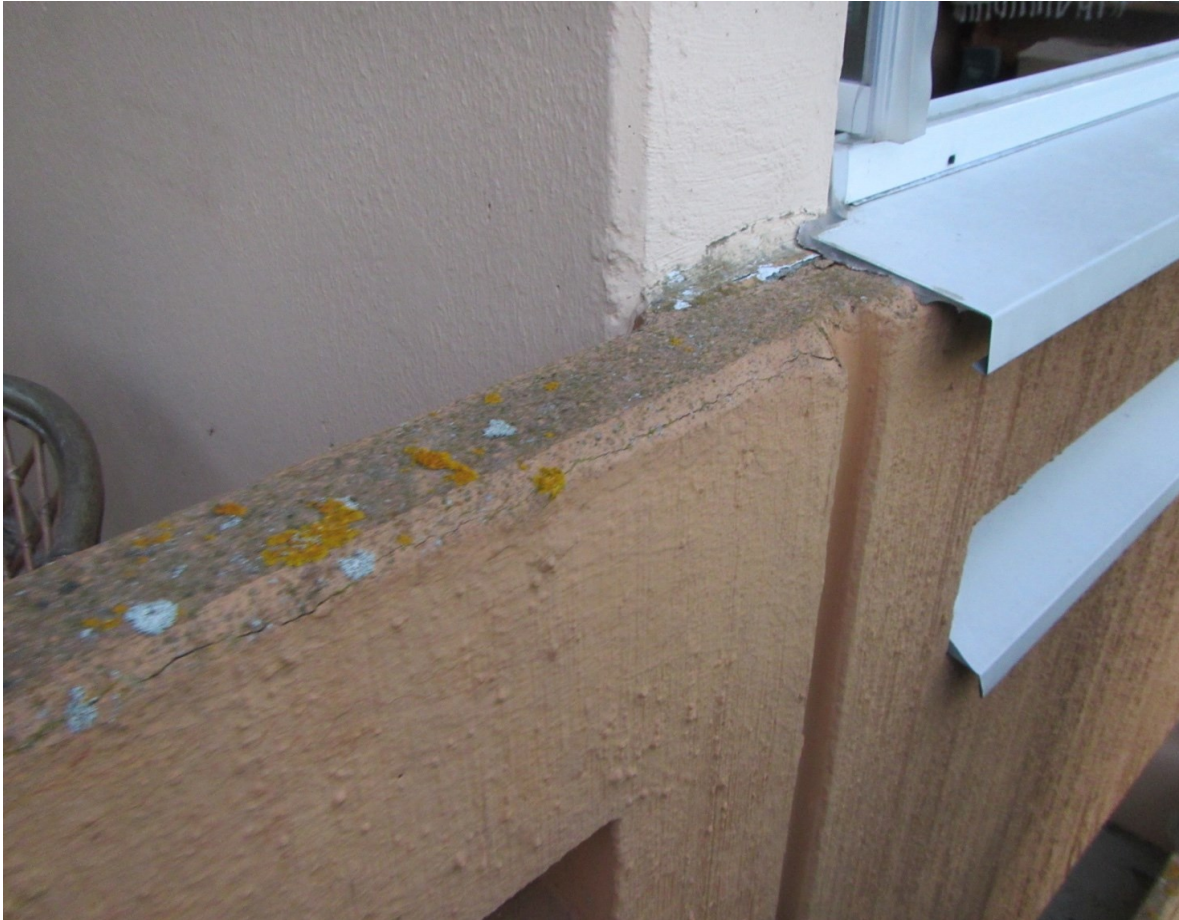
Kuva 30. Lasittamattomat parvekkeet ovat huomattavasti alttiimpia vaurioille. Kaiteiden yläpinnoilla havaittiin paikoin teräskorroosiovaurioita sekä orgaanista kasvustoa (kuva talosta 1).
