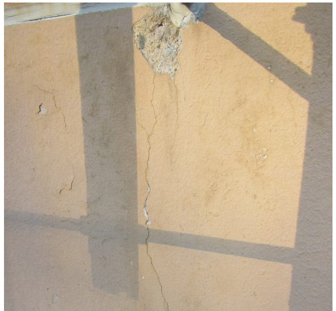
Kuva 5. Talotikkaan kiinnityspisteiden välillä kulkeva halkeama ja korrosiovaurio (talo 3).
