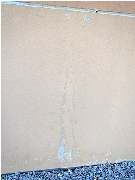
Kuva 7. Sokkeliementin pintarapaamaa, halkeilua sekä irronnutta maalipintaa (talo 3).
