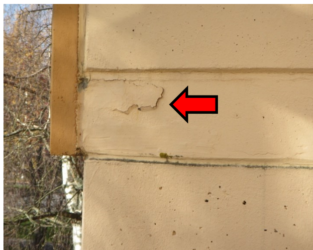
Kuva 25. Parvekepielen ja laatan liittymän korroosiovaurio (talo 2).
