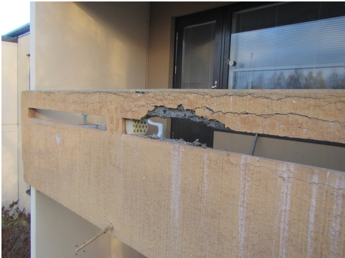
Kuva 19. Kaiteen käsijohde on lähes kauttaaltaan rapautunut
