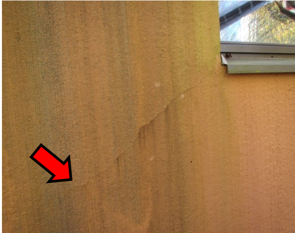
Kuva 2. Pitkälle ulottuva ikkunan alanurkan halkeama ruutuelementissä (talo 2).
