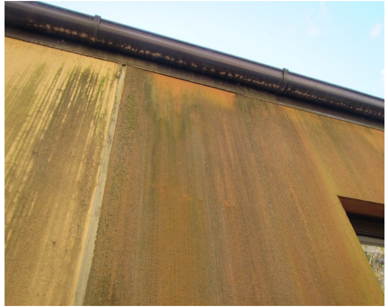
Kuva 15. Yli tulvinut sadevesi tukkiutuneesta sadevesikourusta on rasittanut julkisivupintaa voimakkaasti (talo 2).
