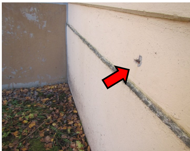
Kuva 24. Yksittäisiä korroosiovaurioita esiintyi jonkin verran kaikkien rakennusten kohdalla (kuva talosta 2).
