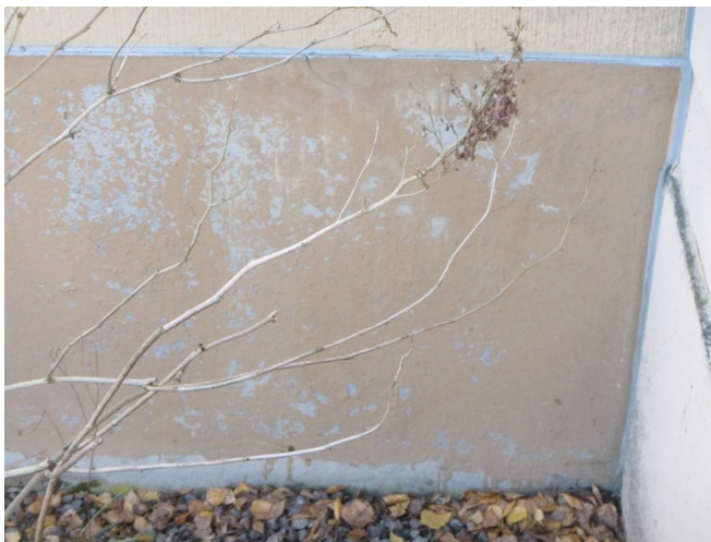
Kuva 12. Sokkeliementin hilseilevää maalipintaa (talo 2).
