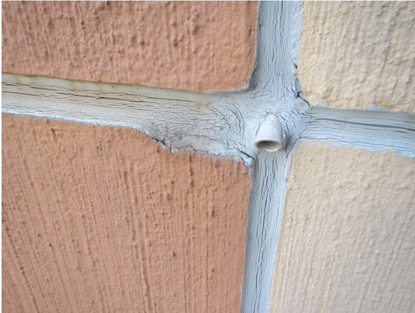
Kuva 6. Elementtien saumat ovat yleisesti heikossa kunnossa (talo 1).
