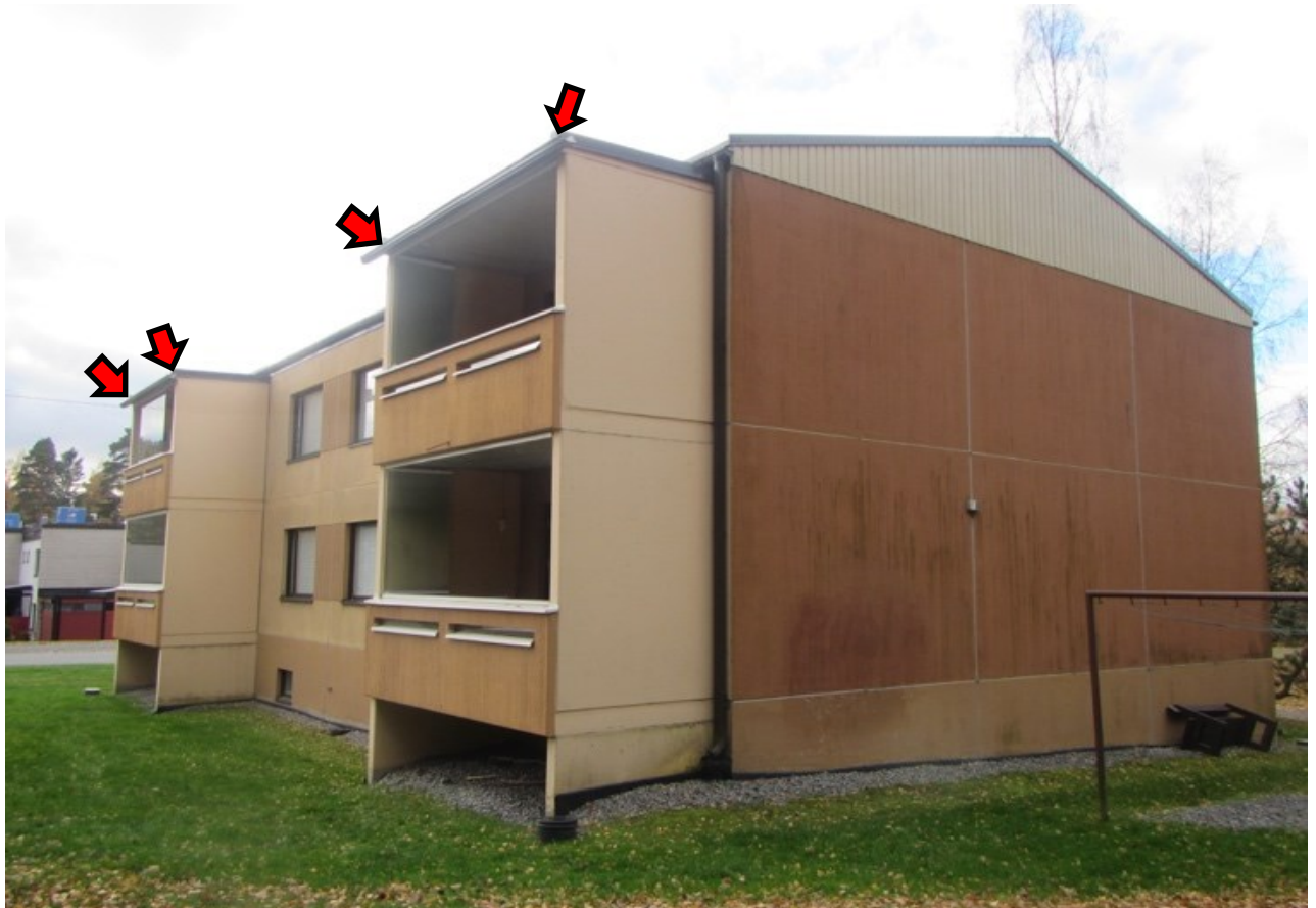
Kuva 20. Kummankin parvekkeen kattolaatan ulkonurkat ovat rapautuneet (talo 3).
