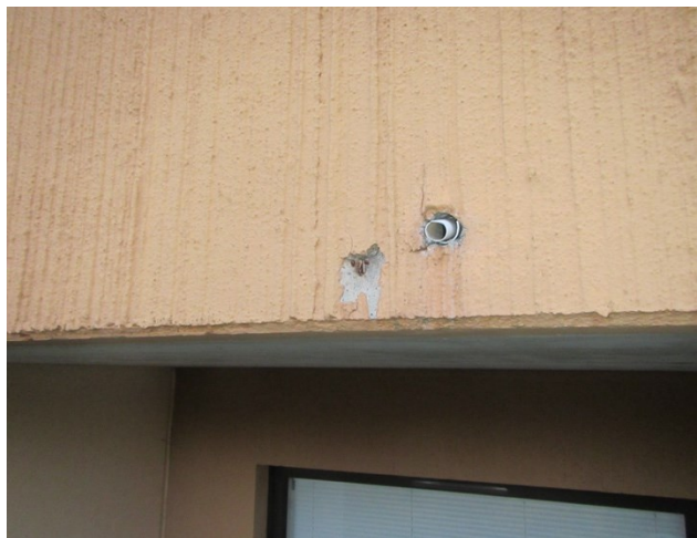
Kuva 23. Korroosiovaurio parvekekaiteen vedenpoiston vieressä (talo 1).
