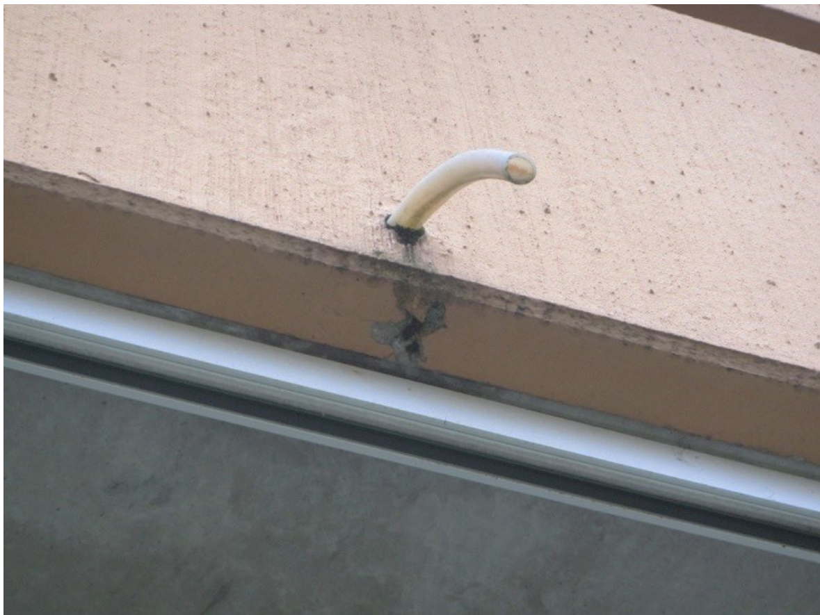
Kuva 29. Vedenpoistoputki on aiemmin puuttunut tai liitoskohta ei ole tiivis ja vesi on päässyt kastelemaan kaiteen alapintaa (talo 2).
