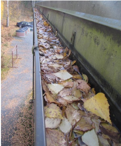
Kuva 14. Tukkiutunut sadevesikouru (talo 2).
