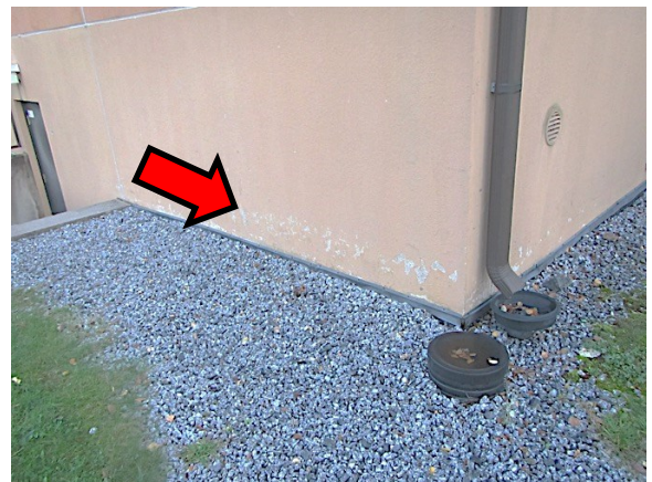
Kuva 13. Talon 1 ja talon 3 maantason pinnoitevauriot ovat todennäköisesti pääosin ajalta ennen rakennusten sokkelien kosteudeneristystä (kuva talosta 1)
