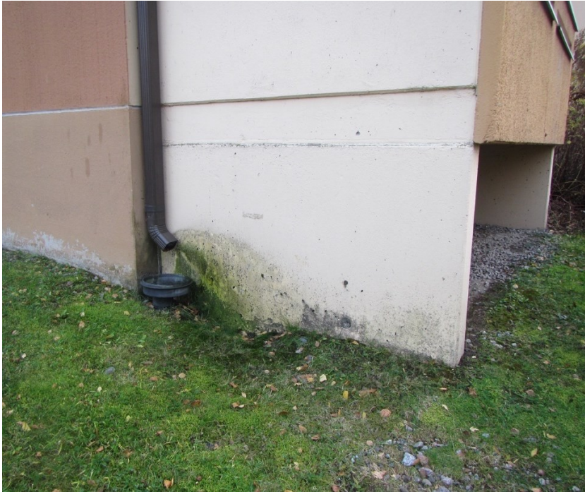
Kuva 16. Syöksytorni roiskii sadevesiä piellelementtiin (talo 2).
