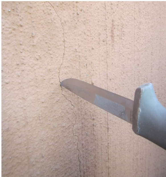
Kuva 4. Umpielementin hiushalkeama (talo 1).
