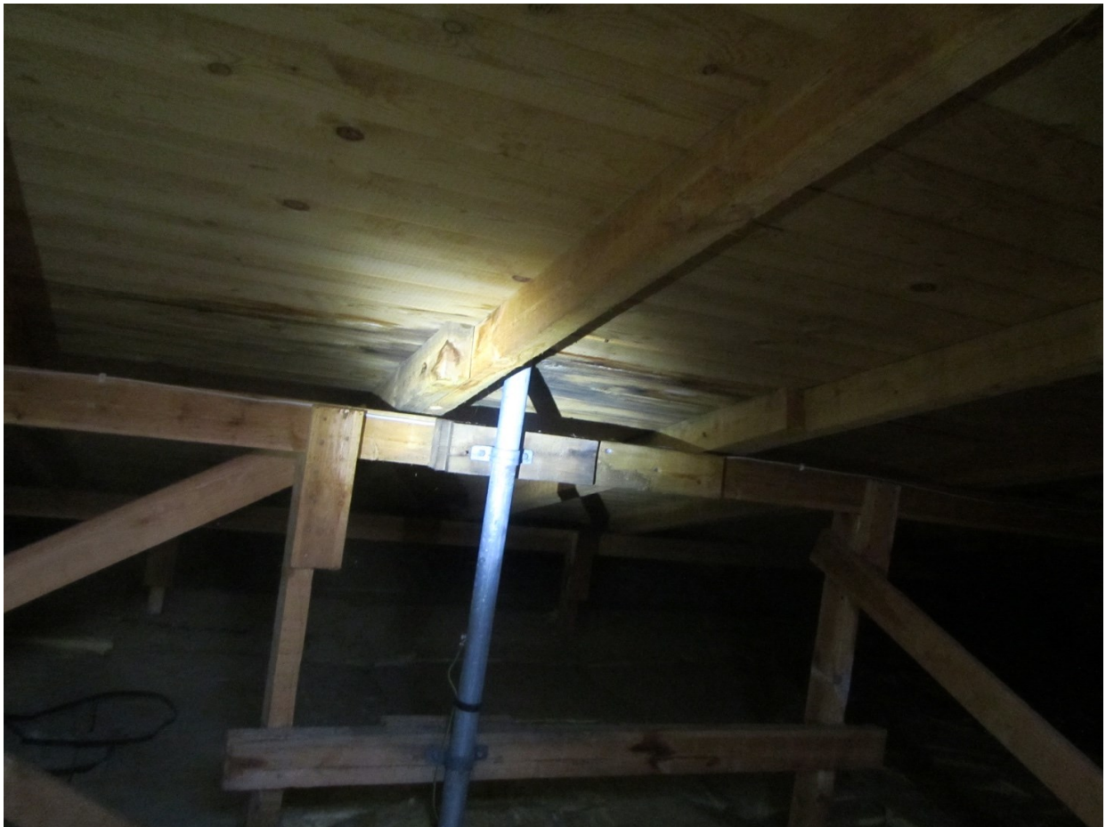
Kuva 33 Vuotojälkiä kattoantennin läpiviennin kohdalla (talo 1).
