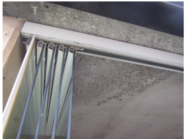
Kuva 22. Kattolaattojen kulmien alueet olivat pinnoiltaan pesetyneet, mutta vasaroitaessa vielä kovia.
