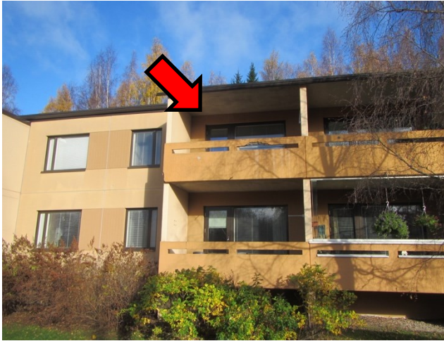
Kuva 17. Käyttökieltoon asetettu huoneistoparveke (talo 2).
