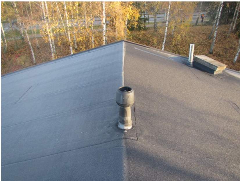
Kuva 31. Talojen vesikatteista ei löytenyt merkittäviä puutteita.
