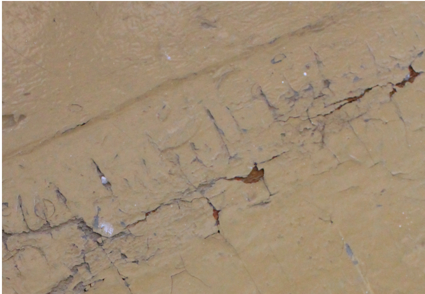
Kuva 6. Kirkkosalin lattian maalipinnan vaurio.
