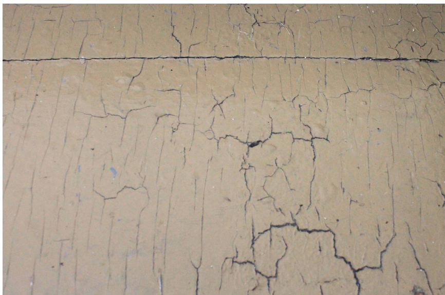
Kuva 9. Eteisen lattiamaalin vauriot.
