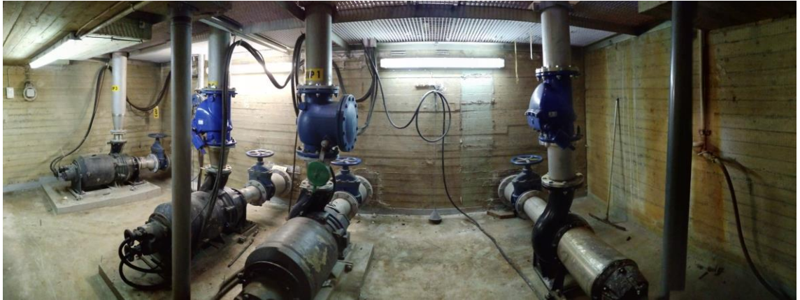
KUVA 6. Pähkinäkallion jätevesipumppaamon pumppusali
