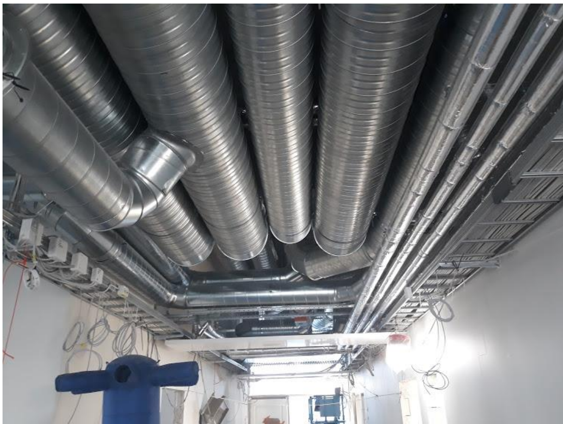
Kuva 23. Tekniikkaa alakaton yläpuolella.
