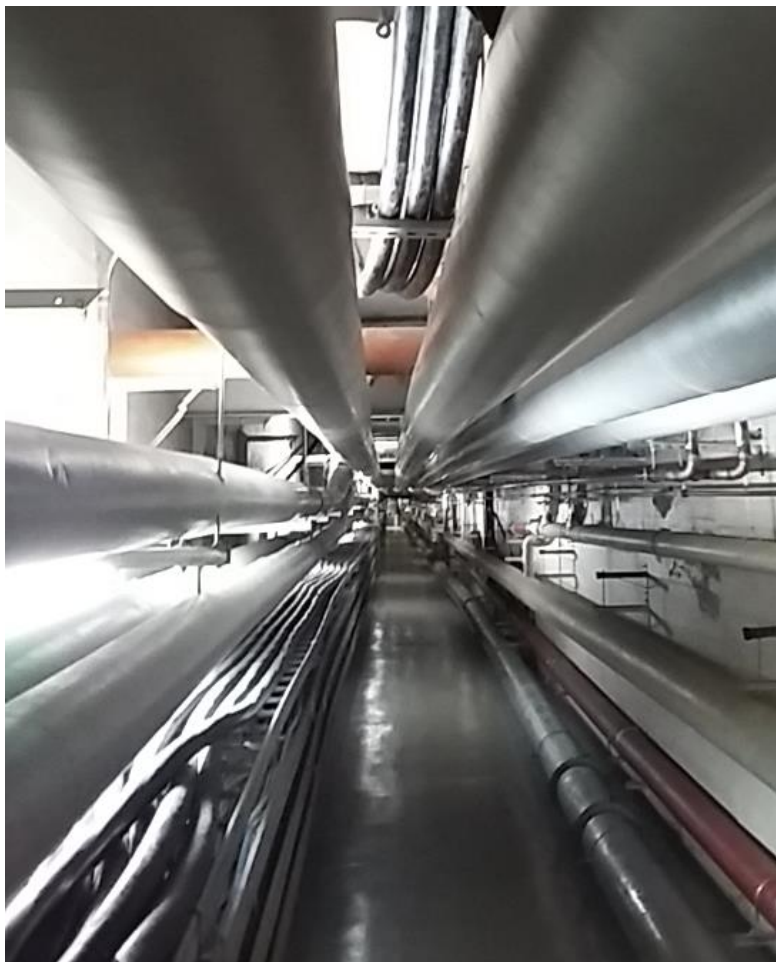
Kuva 14. Kuva KYS:n huoltotunneleista. (Tolvanen, KYS huoltotunneli, 2018)
