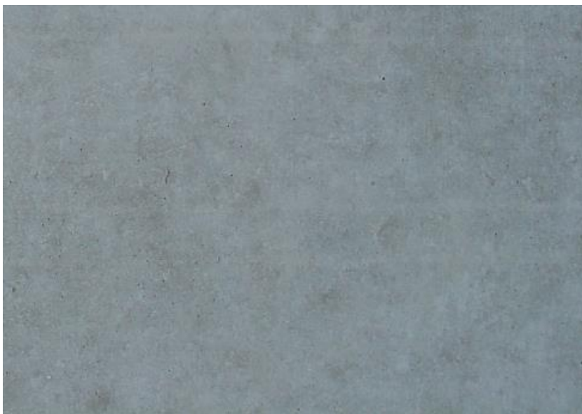
KUVA 11. Hierretty betonipinta (Betonirakenteiden pinnat. Luokitusohjeet 2003. BY40. Helsinki. Suomen Betonitieto)
