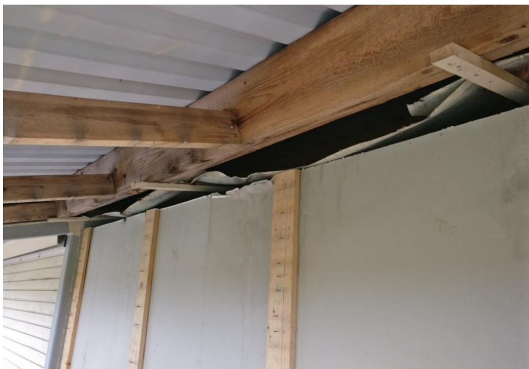
Kuva 14. Aluskate asennettu väärin, jolloin vesi on valunut seinärakenteisiin aiheuttaen kosteusvauriota. Kuva: Fise 2017.
