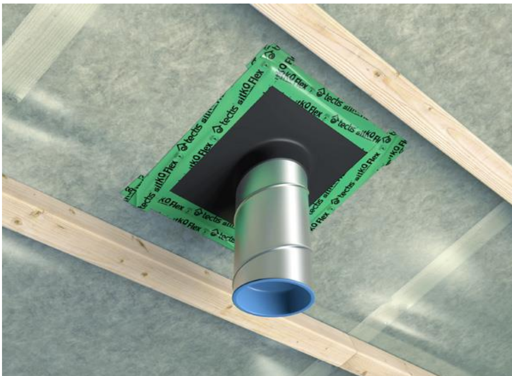
Kuva 19. Ilmastointiputken tiivistyskaulus asennettuna. Kuva: Talotarvike 2018.
