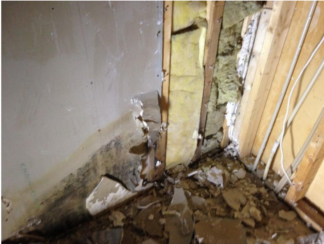
Kuva 23. Kosteusvaurio kylpyhuoneessa. Vedeneristys on ollut puutteellinen. Kuva: Saunatohtori 2016.
