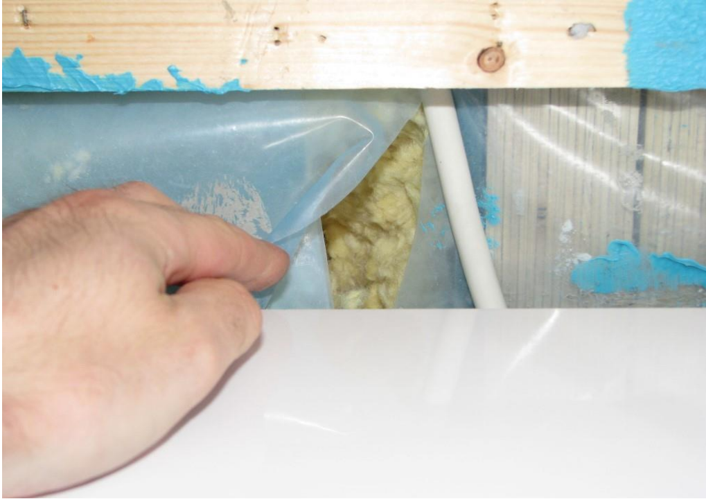
Kuva 17. Höyrnsulkumuovissa sähköjohdon läpivienti teippaamatta. Kuva: FISE 2016.
