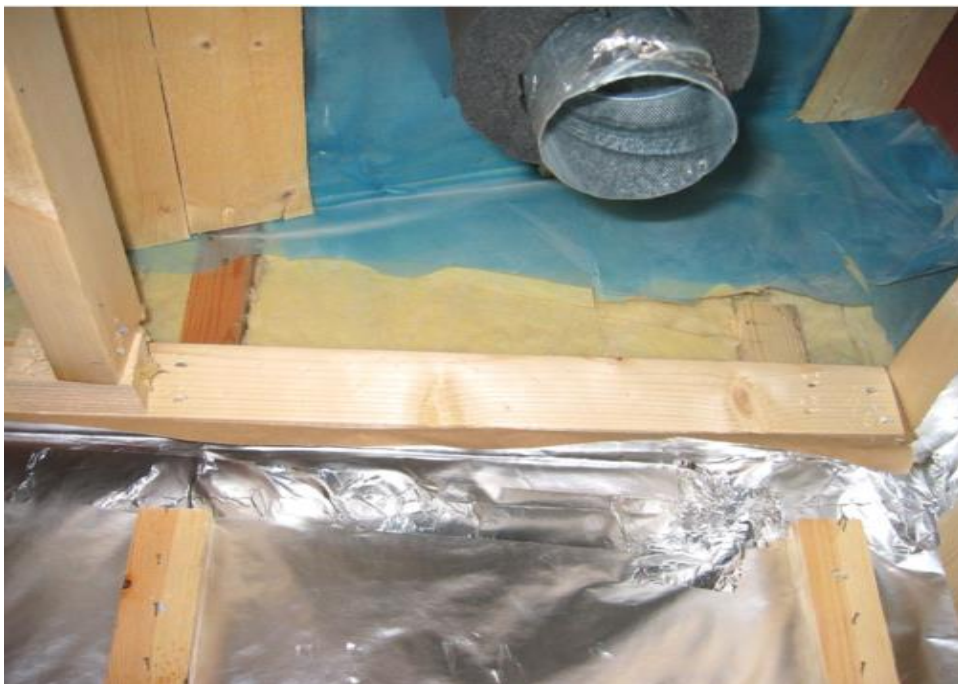
Kuva 16. Höyrinsulkumuovi puutteellinen alakatossa. Kuva: FISE 2016.
