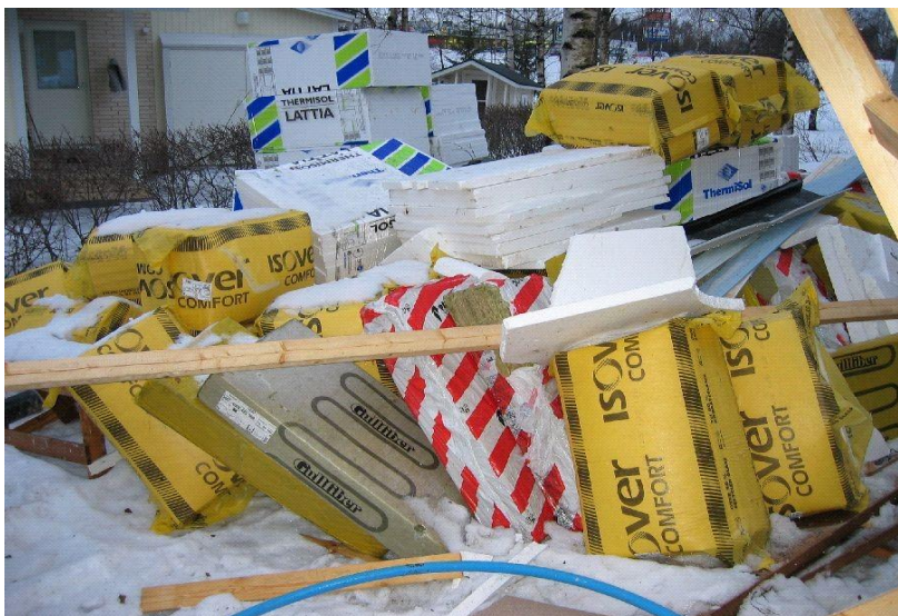
Kuva 2. Ilman suojausta jääneet lämmöneristeet ovat kastuneet ja kovat eristyslevyt ovat vaurioituneet. Kuva: Fise 2016.
