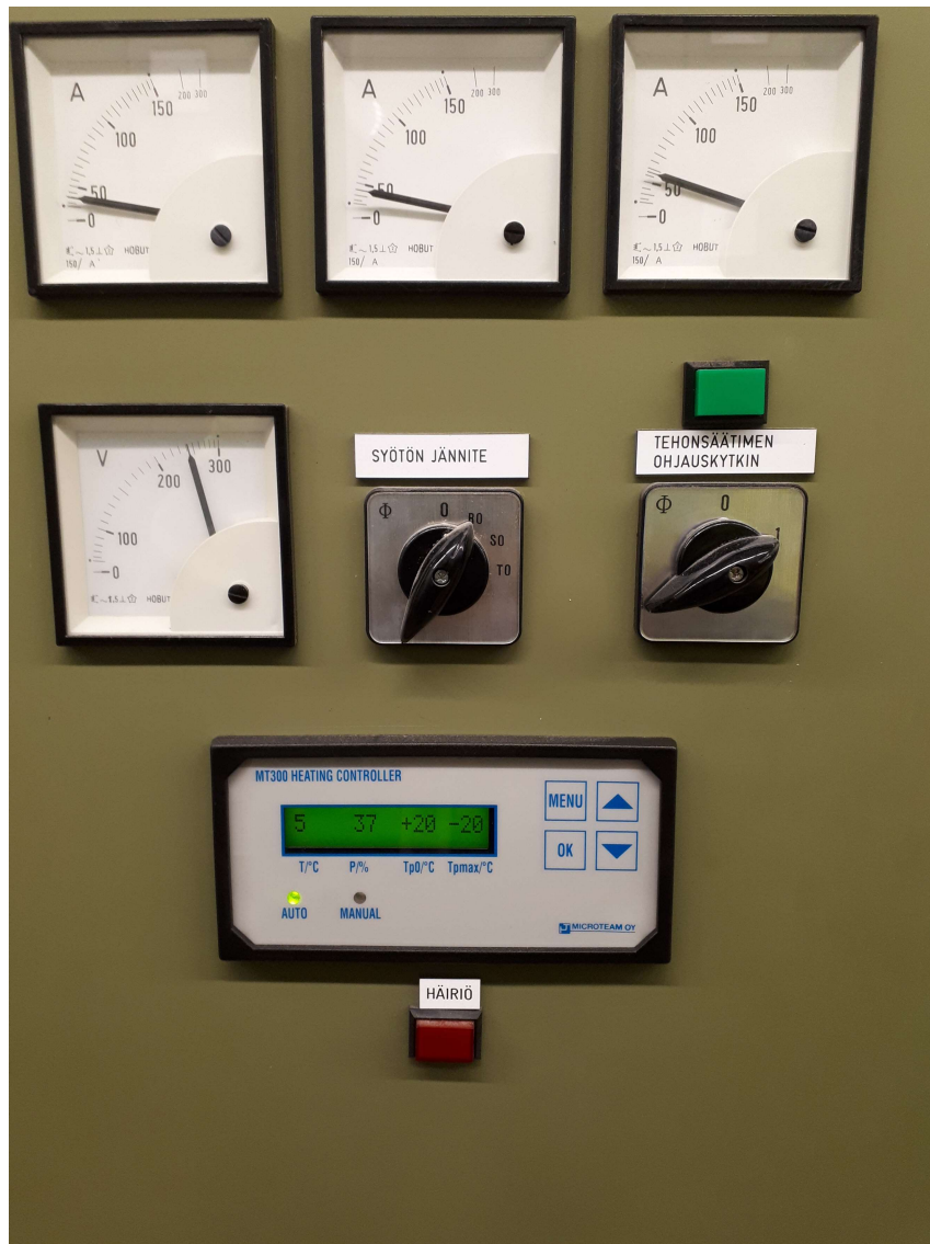
Kuva 8. Tyristorisäätimen valvonta ja ohjaus.
