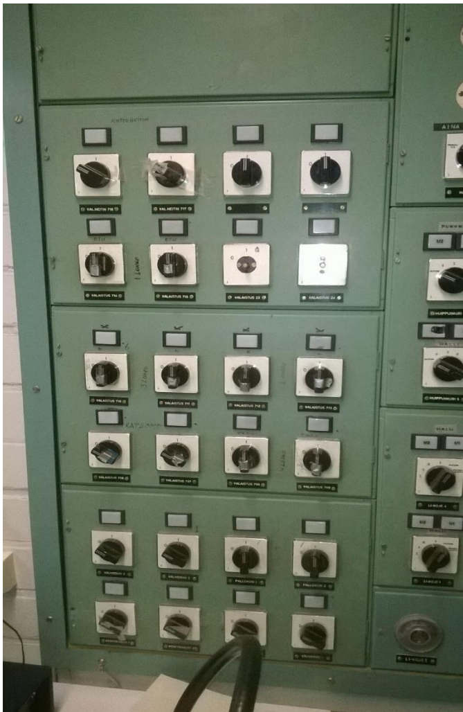
Kuva 6. Liikuntasalin valaistuksen ohjaus kytkimillä
