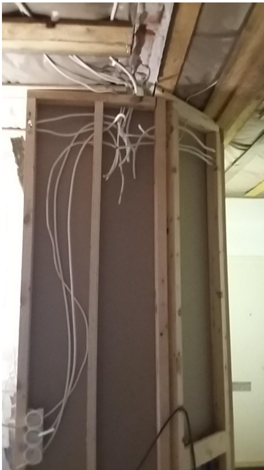
Kuva 7. Asunnon suurin sähköjen risteämäkohta, johon sijoitettiin kolme jakorasiaa
