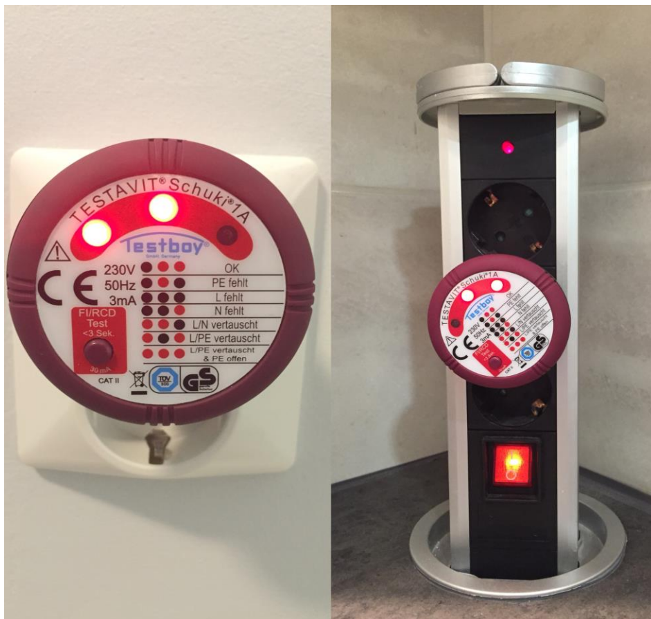
Kuva 8. Schuki-testerin käyttöä. Vasemmalla puolella vaihe- ja nolla-johdin on kytketty väärin päin, pylväspistorasia oikealla on kytketty oikein.
