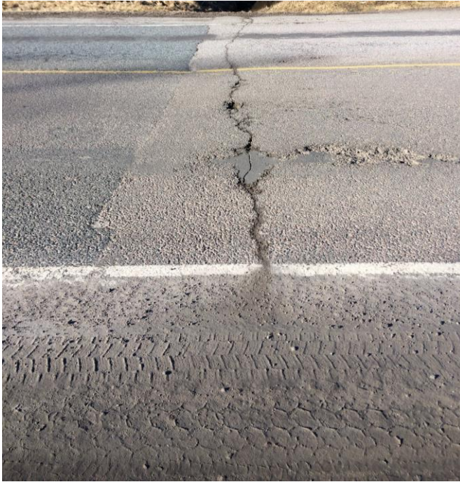
KUVA 8. Päällyste vaurioitunut rummun kohdalta (Sitowise 2017)
