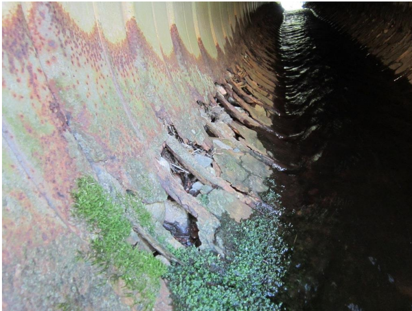
KUVA 7. Rumpu ruostunut puhki (Sitowise 2016)
