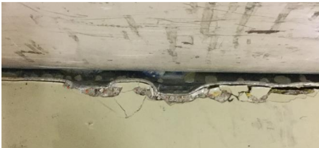
Kuva 3: Vääntynyt teräspalo-oven kynnyks. (Töyrylä).
