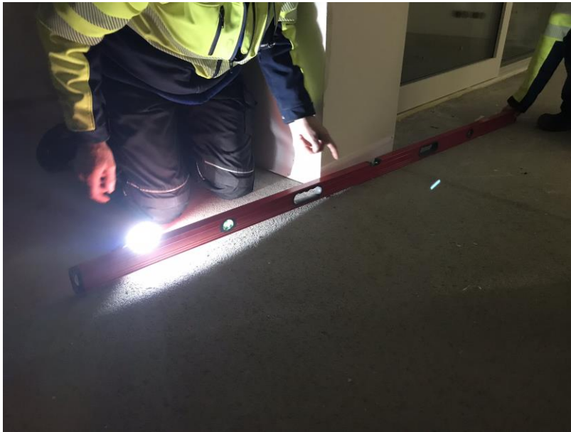
KUVA 19. Ulkoseinän ulkokulma on korkealla
