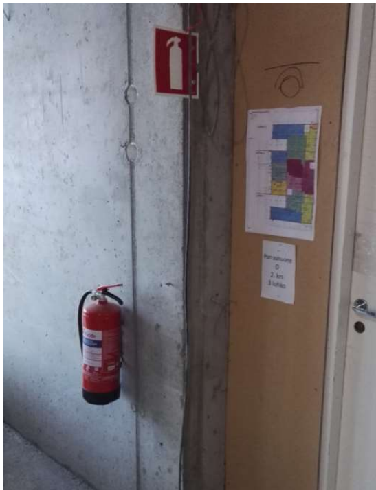
Kuva 12. Kulkureitin läheisyydessä oleva yleissammutin ja kerroksen pelastussuunnitelma. (Kajaanin sairaalan työmaalta 2018.)
