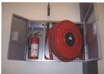
Kuva 14. Kaappiin asennettu kääntyvä pikapalopostikelä ja käsiammutin. (Majamaa 2011, 9.)
