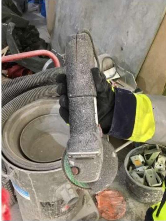
Kuva 36. TR-mittauksessa työmaalta löytynyt hajonnut kulmahiomakone, josta puuttui myös käsikahva. (Kajaanin sairaalan työmaalta. 2018)
