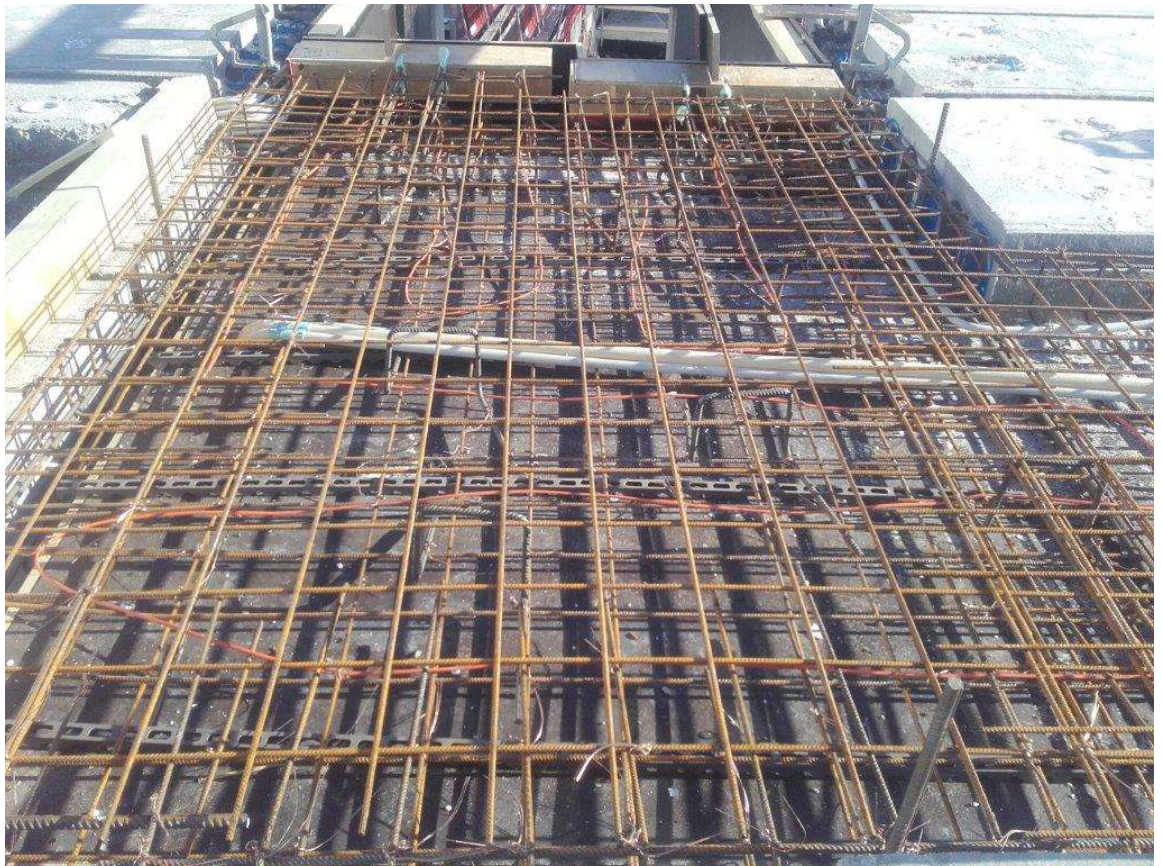
Kuva 4. Holvin lämmityskaapelit. (Kuva: Miika Kyllönen)
