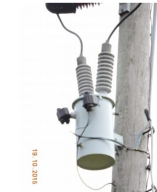
Kuva 17. Kauko-ohjattava erotin (Rantala 2015, 15).
