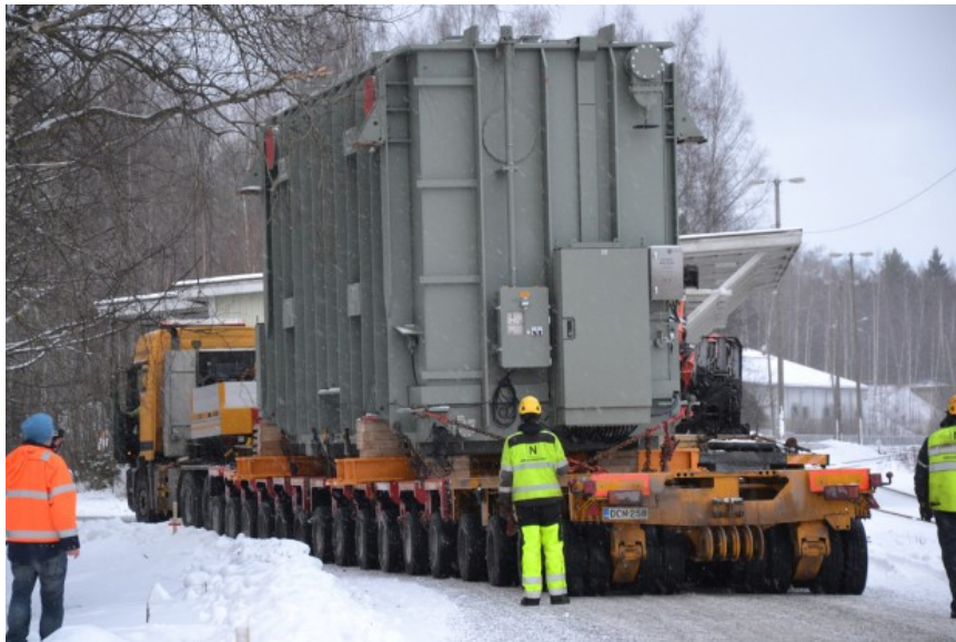
Kuva 15. 400 kilovoltin ja 400 megavoltiampeerin suurmuuntaja (Shl 2015).
