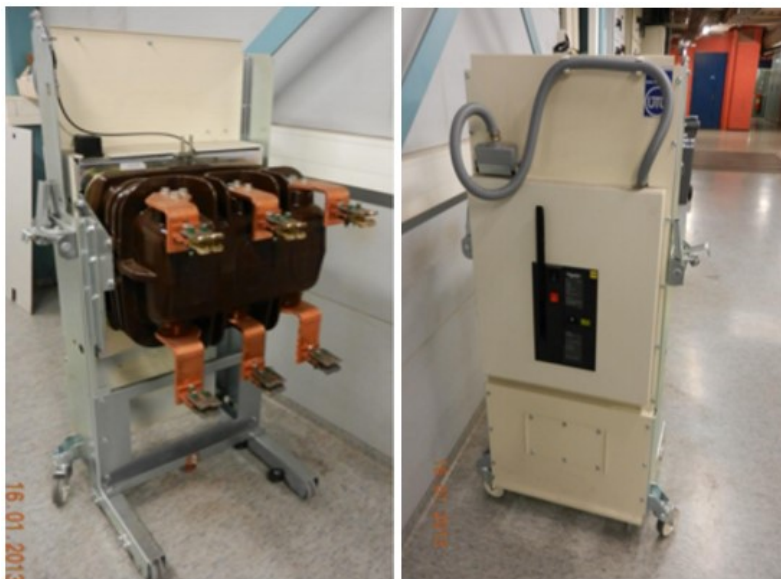
Kuva 21. Tyhjiö/SF6 -katkaisija vasemmassa kuvassa takaa ja oikeassa kuvassa edestä (Rantala 2015, 24).
