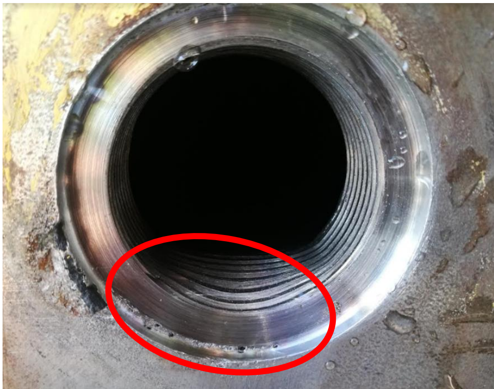
Kuva 23. Syöpymää tiivistepinnan ulkolaidalla [28].
