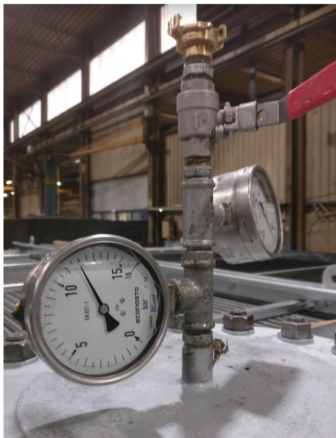
Kuva 38. Painemittarit kiinnitettynä laipan kanteen. Kokeessa käytetään kahta mittaria, jotta mitaustulosten eroaisuutta voidaan seurata. Mittareiden tulee olla kalibroitu ja kalibroinnista on oltava todistus [31].
