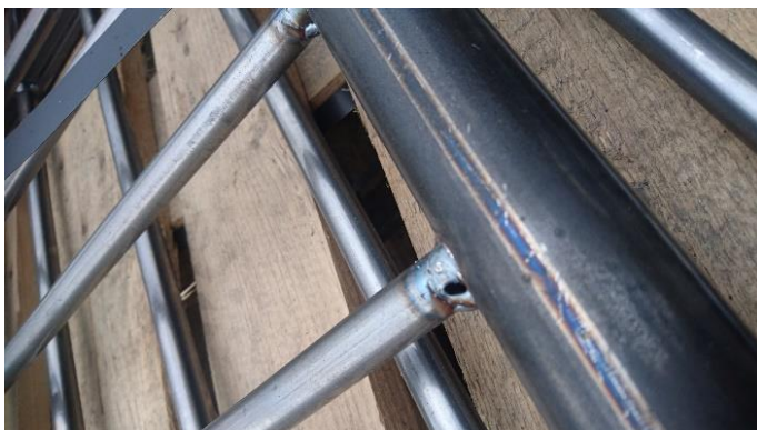
Kuva 7. Sinkkireikä pinnakaiteen pinnassa (Rissanen I. 2017).
