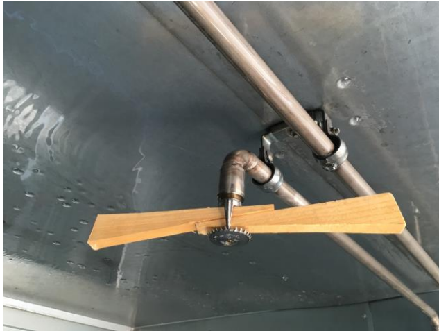
Kuva 8: Sprinklerin suuttimesta estetty kiilloilla sammutusvesivirta, kun tulipalo on sammutettu palokunnan toimesta.
