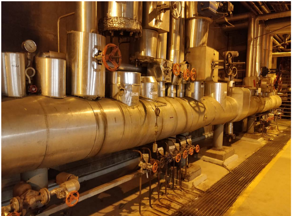
Kuva 8. Haapaniemen voimalaitoksen höyryn jakotukki
