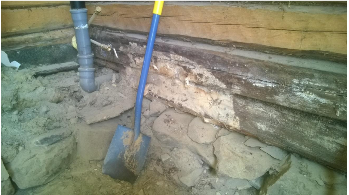
Kuva 7. Lattiasienikasvusto keittiön tiskialtaan kohdalla
