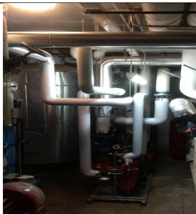
Yleiskuva lämmönjako- huone
