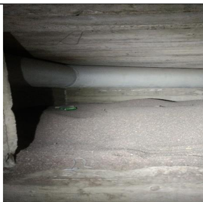
Väestönsuojan ilmanvaih- tokoneen hiekkasuodatin
