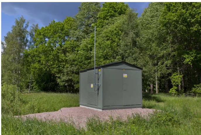
Kuva 3. KL Industrin Elit-sarjan puistomuuntamo. [8.]
