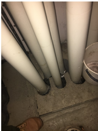
Kuva 20. Lämmitysputkien läpiviennit eivät olleet tiiviit.
