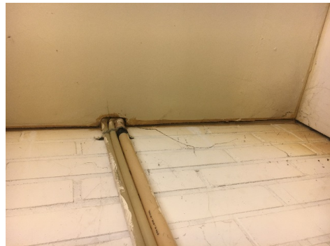
Kuva 26. Seinät olivat likaiset ja läpivientireikää ei ollut tiivistetty.
