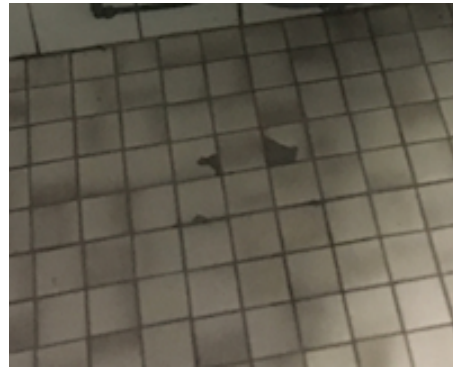
Kuva 16. Lattialaatat olivat halkeilleet
