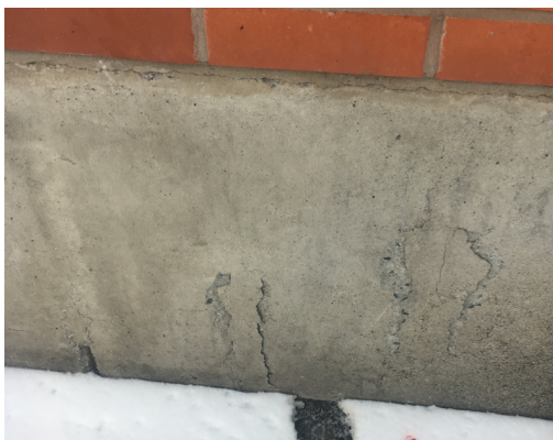
Kuva 5. Sokkeli oli halkeillut.
