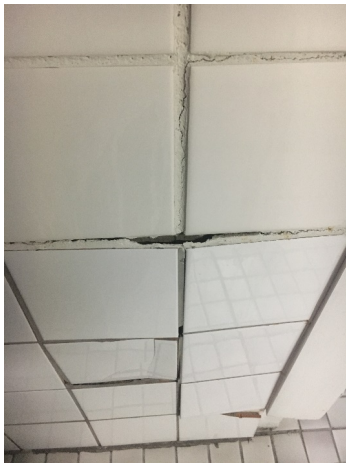
Kuva 17. Seinälaatat olivat halkeilleet.
