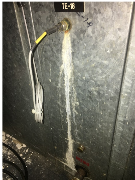
Kuva 25. Sähköjohdon läpiviennissä oli valumajälkiä.
