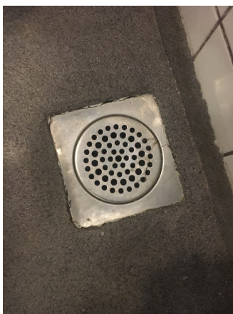
Kuva 19. Lattiakaivon saumat olivat huonossa kunnossa.
