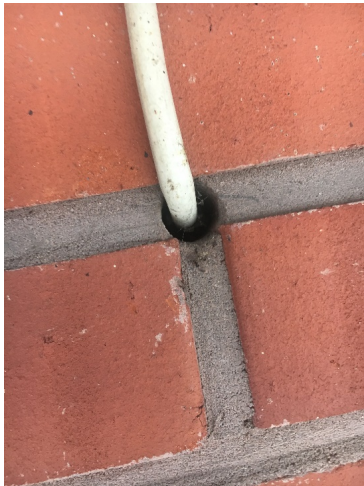
Kuva 13. Läpivientireikää ei ollut tiivistetty.
