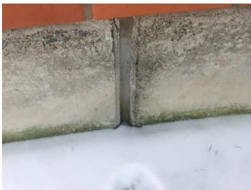
Kuva 7. Sokkelin alareunassa havaittiin sammalkasvustoa.
