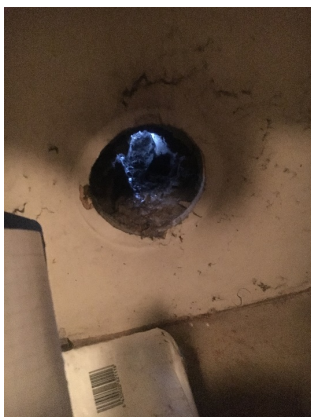
Kuva 22. Ilmanvaihtokanavat olivat likaisia.
