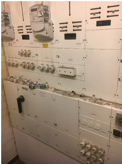
Kuva 25. Sähköpääkeskuksen yleinen siisteys oli huono.
