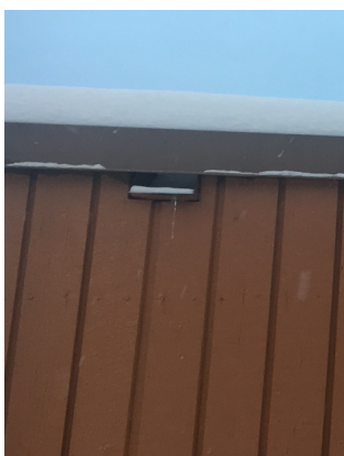
Kuva 3. Katon sadevesikouru oli liian lyhyt.
