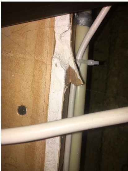
Kuva 24. Kipsilevyn reuna oli rikkoutunut.
