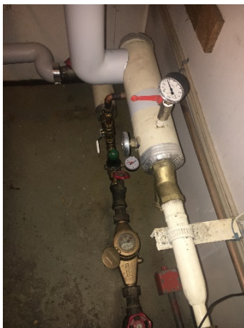
Kuva 23. Päävesimittari sijaitsee lämmönjakohuoneessa.
