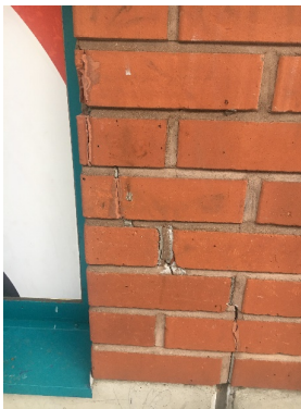
Kuva 9. Julkisivu oli halkeillut.
