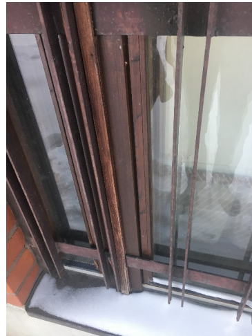
Kuva 14. Ikkunat olivat huonossa kunnossa.
