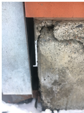
Kuva 6. Sokkelista oli lohjennut paloja.
