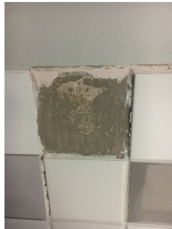
Kuva 18. Seinälaatta oli irronnut.
