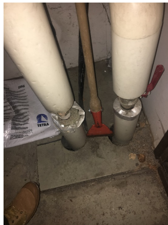
Kuva 21. Putkieristeet olivat huonossa kunnossa.
