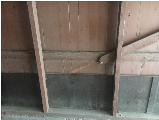
Kuva 8. Autokatoksen vinotuki oli poikki.
