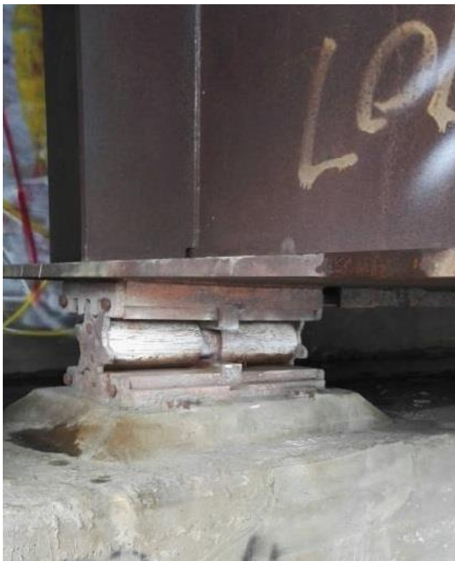
Kuva 19. Laakerista puuttuu suoja, merkintä D
