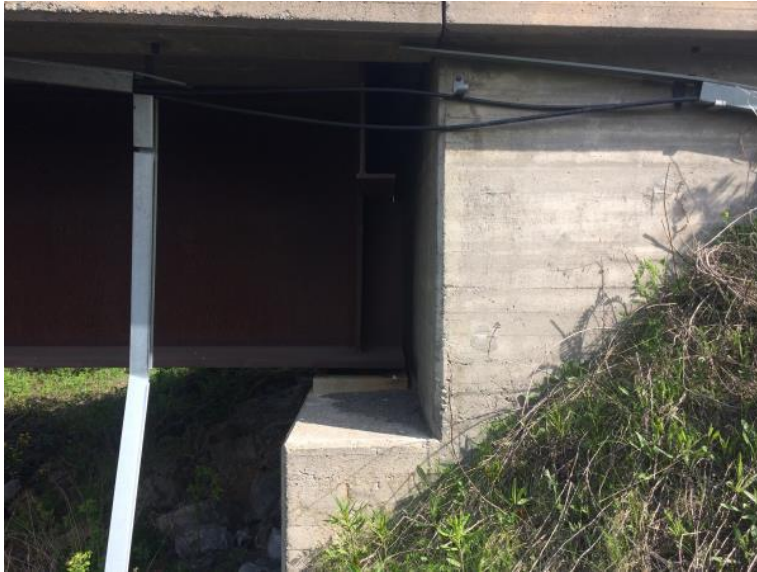
Kuva 24. Kaapelikouru irronnut, merkintä D
