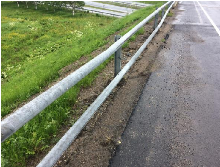
Kuva 16. Kaideputki irronnut kannattimelta, kunnostettava
