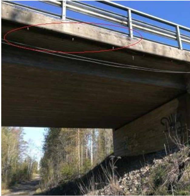
Kuva 21. Tippuputket ajoradan yllä, merkintä D
