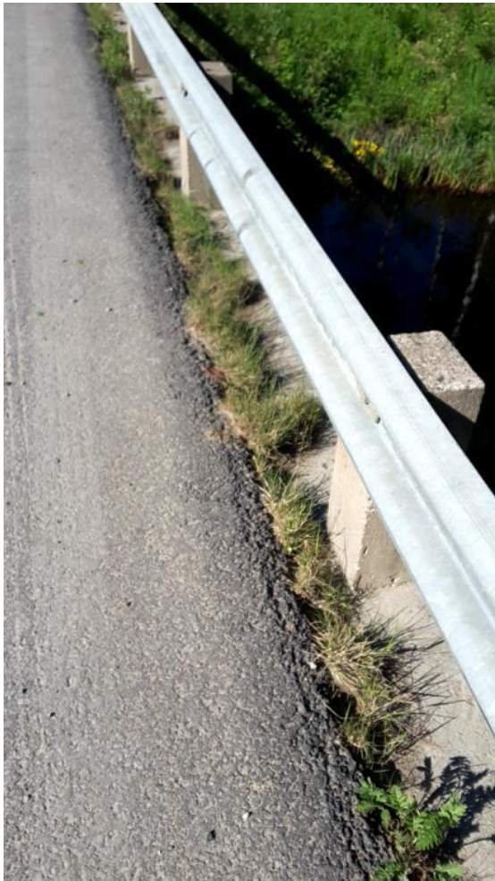
Kuva 13. Sauma peittynyt uuden päällysteen alle ja pahasti heinittynyt, merkintä D
