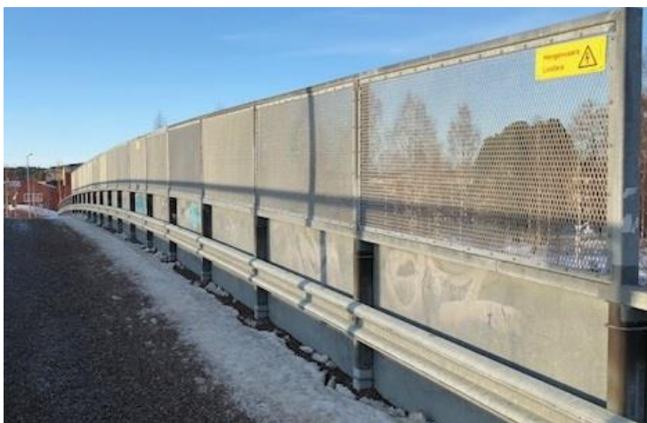
Kuva 22. Hyvässä kunnossa oleva kosketussuoja, merkintä A
