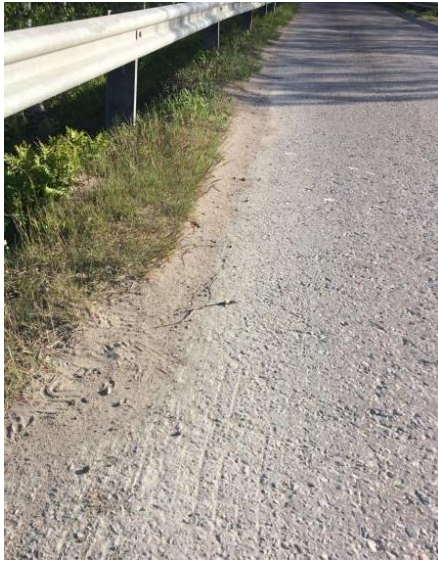
Kuva 28. Tieluiskassa reunapalletta, merkintä C
