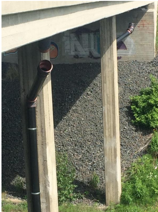
Kuva 20. Syöksytorvet rikki, merkintä D.
