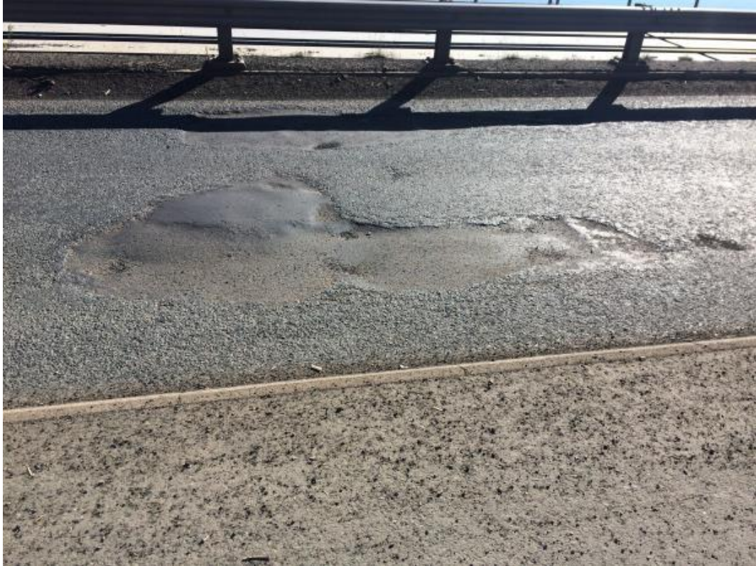
Kuva 9. Päällysteessä nähtävissä laajalti vaurioita, merkintä D
