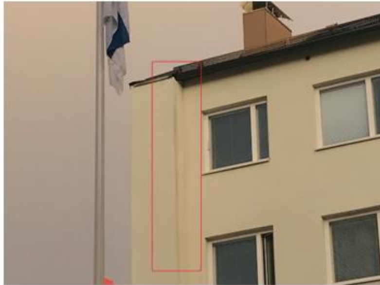
Kuva 9. Vesikatteen reunapelliltä havaittua vesivalumaa julkisivupinnalle
