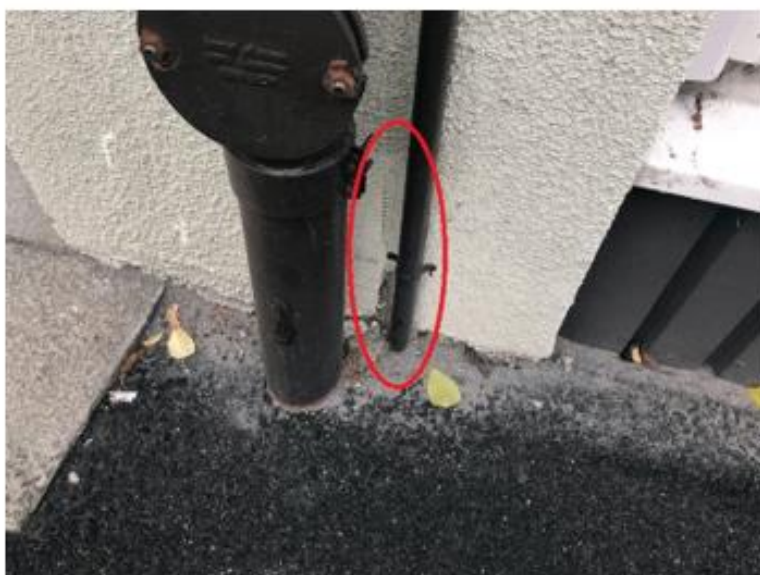
Kuva 4. Puuttuva rappauspinnote Kasarmikadun puolella
