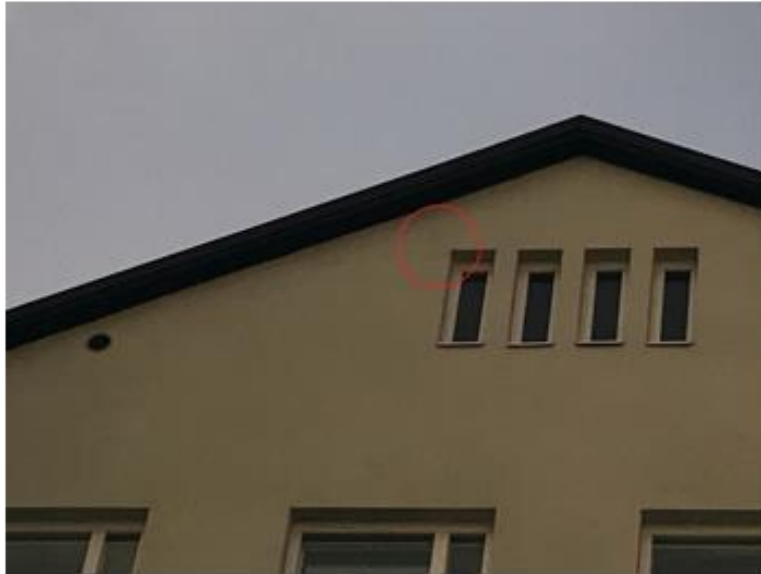
Kuva 7. Rappauspinnoitteen paikkakorjaukset erottuvat valmiista julkisivupinnasta
