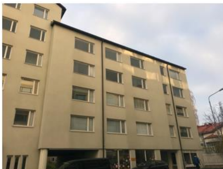
Kuva 6. Rappauspinnoitteessa havaittuja sävyeroja Kauppakadun puolella
