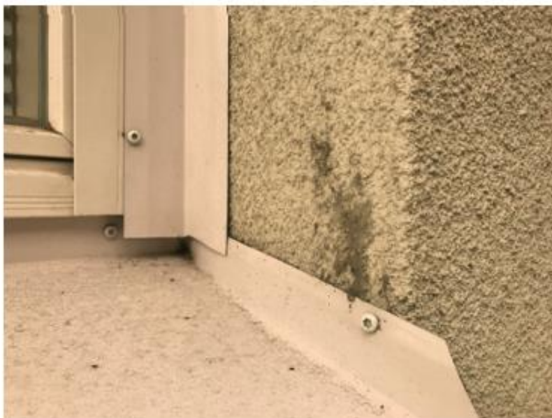
Kuva 13. Silikonijäämiä ikkunan tippapellin yhteydessä Kauppakadun puolella
