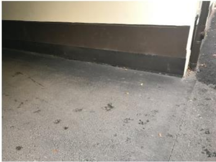
Kuva 1. Kongin suojaellin alaosassa on rako. Toisen sivun suojaelti on kiinni asfaltissa
