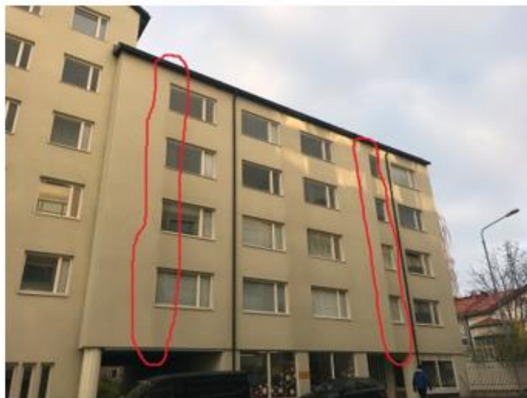
Kuva 5. Rappauspinnoitteessa havaittuja sävyeroja Kauppakadun puolella
