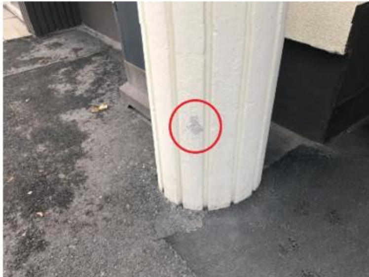
Kuva 2. Maalipinnoitteen hilseilyä kongin vierustalla olevissa pilareissa
