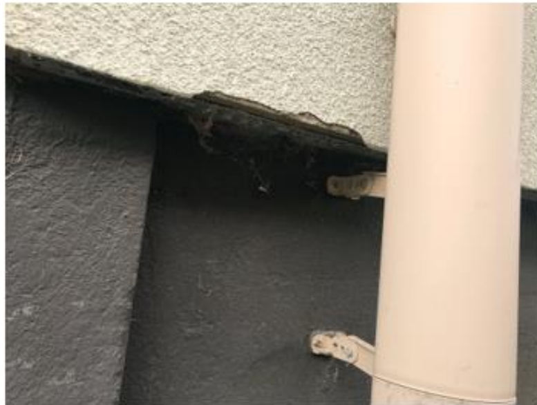
Kuva 10. Lohjennut rappauspinnote julkisivun alaosassa Kauppakadun puolella
