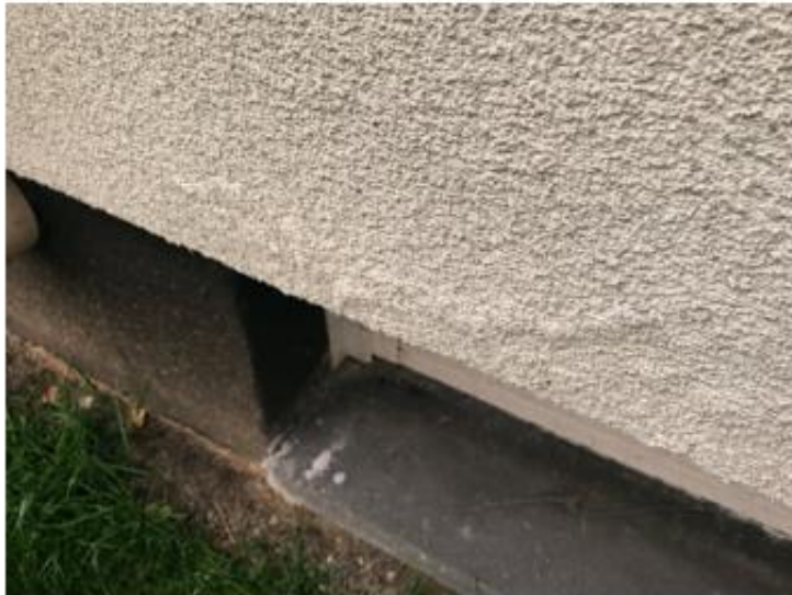
Kuva 11. Lämpörappausvillan alaosaa ei ole suojattu Kauppakadun puolella ja villaeriste on alaosastaan märkää. Rappauspinnoite on paikoin irronnut alustastaan
