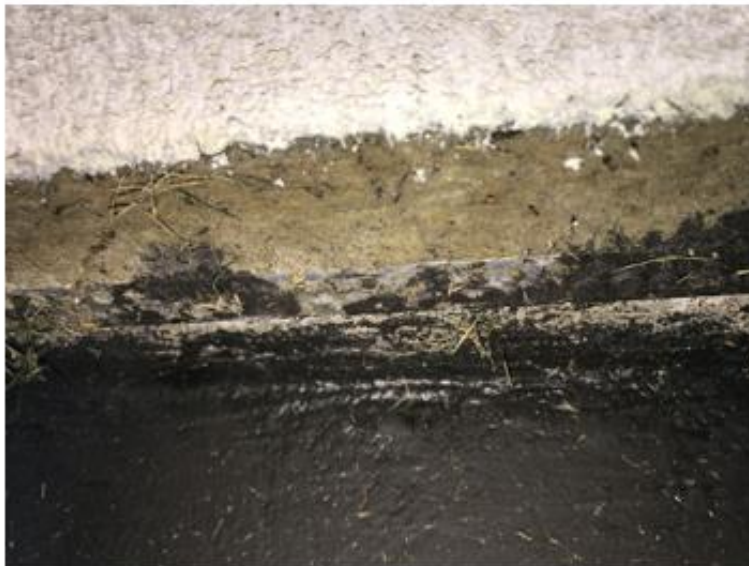
Kuva 12. Lämpörappausvillan alaosaa ei ole suojattu Kauppakadun puolella ja villaeriste on alaosastaan märkää. Rappauspinnoite on paikoin irronnut alustastaan
