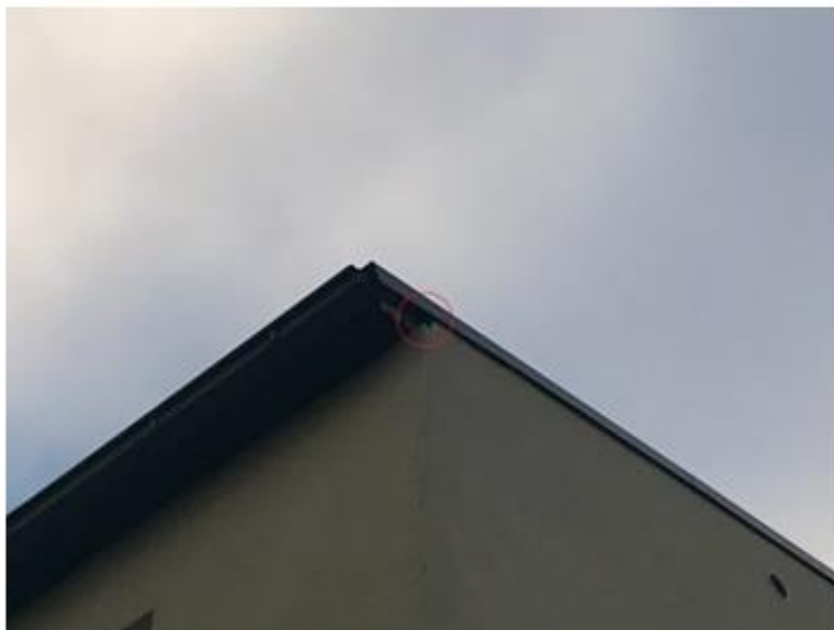
Kuva 3. Avoin rakenne ulkoseinärakenteen yläosassa Kasarmikadun puolella
