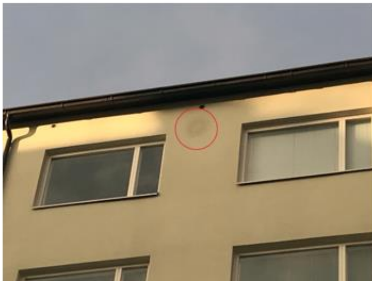
Kuva 8. Rappauspinnoitteen paikkakorjaukset erottuvat valmiista julkisivupinnasta
