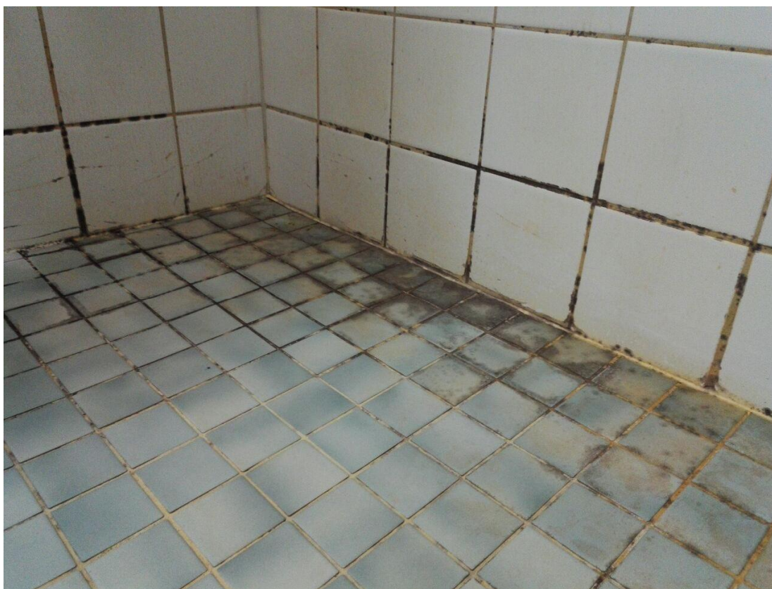
KUVA 4. Kosteusvaurion ilmenemä haljenneissa laatoissa ja vaurioituneissa saumoissa. (Kinnunen 2017)
