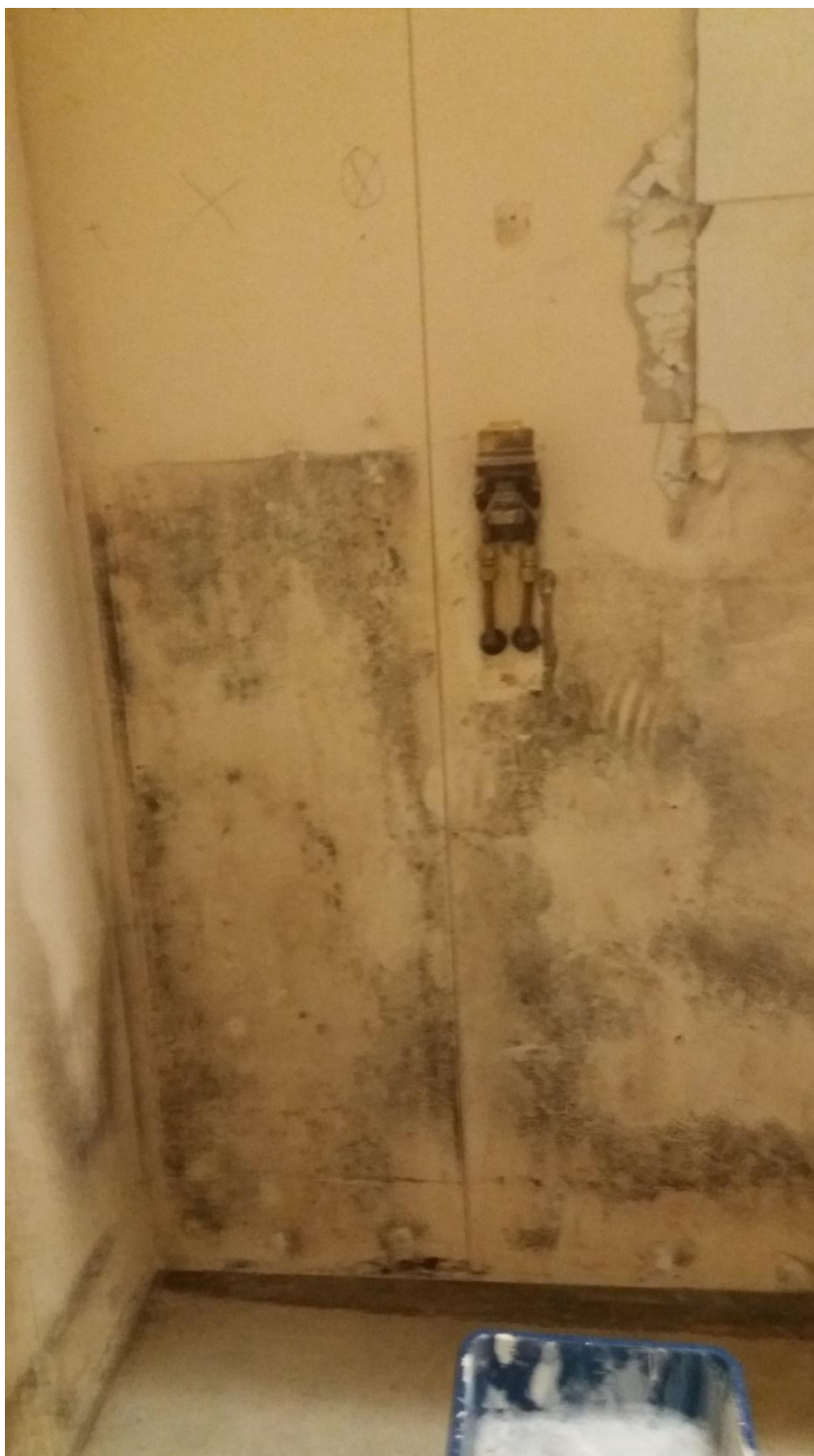
KUVA 6. Pinnotteiden ja kipsilevyjen alta paljastunut mikrobivaurio (Kinnunen 2017)
