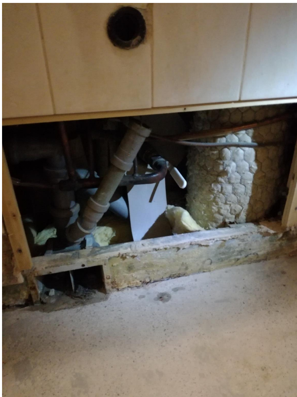
KUVA 3. Seinäkaivon nielu ja yleiskuvaus viemäröinnistä (Kinnunen 2017).
