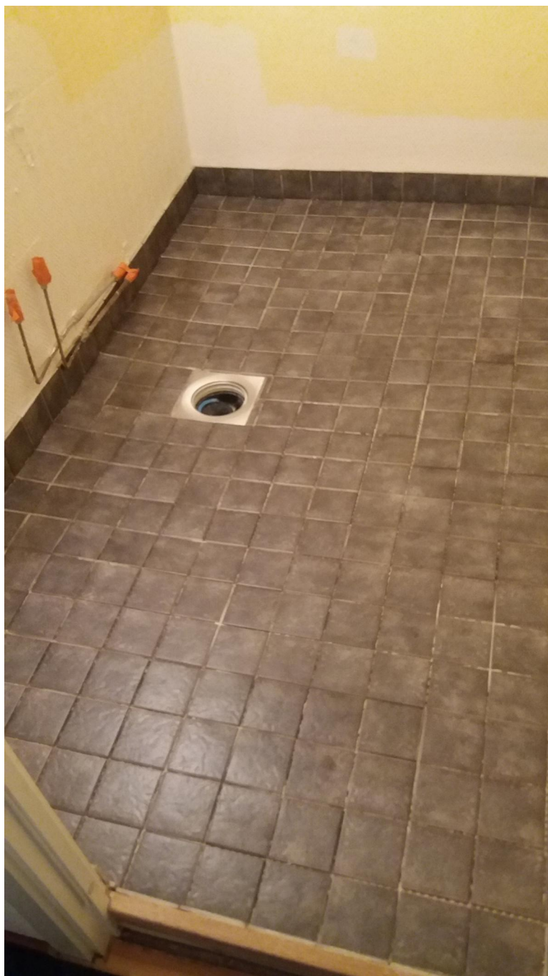
KUVA 12. Laatoitettu lattia ja ylösnosto (Kinnunen 2017)
