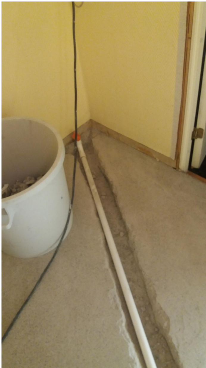
KUVA 10. Pyykinpesukoneelle roilotettu poistoputki (Kinnunen 2017)
