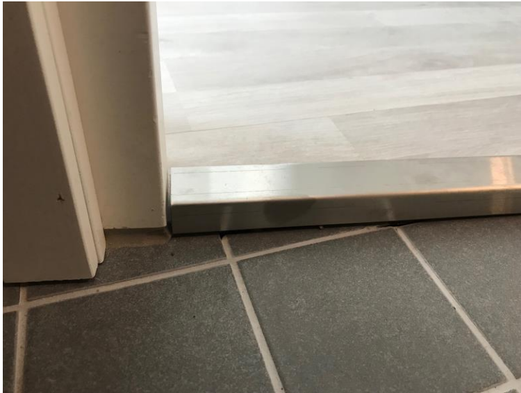
Kuva 6. Kynnyksestä puuttuu silikoni (Kuva: Joonas Kähkönen).
