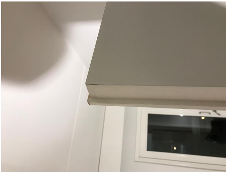
Kuva 5. Oven maalit halkeilleet (Kuva: Joonas Kähkönen).
