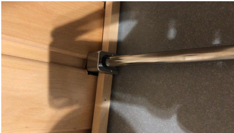
Kuva 4. Katossa läpiviennin reikä liian iso (Kuva: Joonas Kähkönen).
