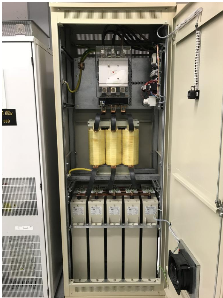
KUVA 17. Yliaaltosuodattimen ovi avattuna
