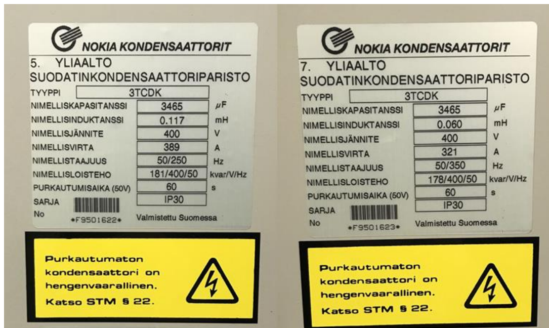
KUVA 16. 400 V -jännitetason yliaaltosuodattimien kilpiarvot
