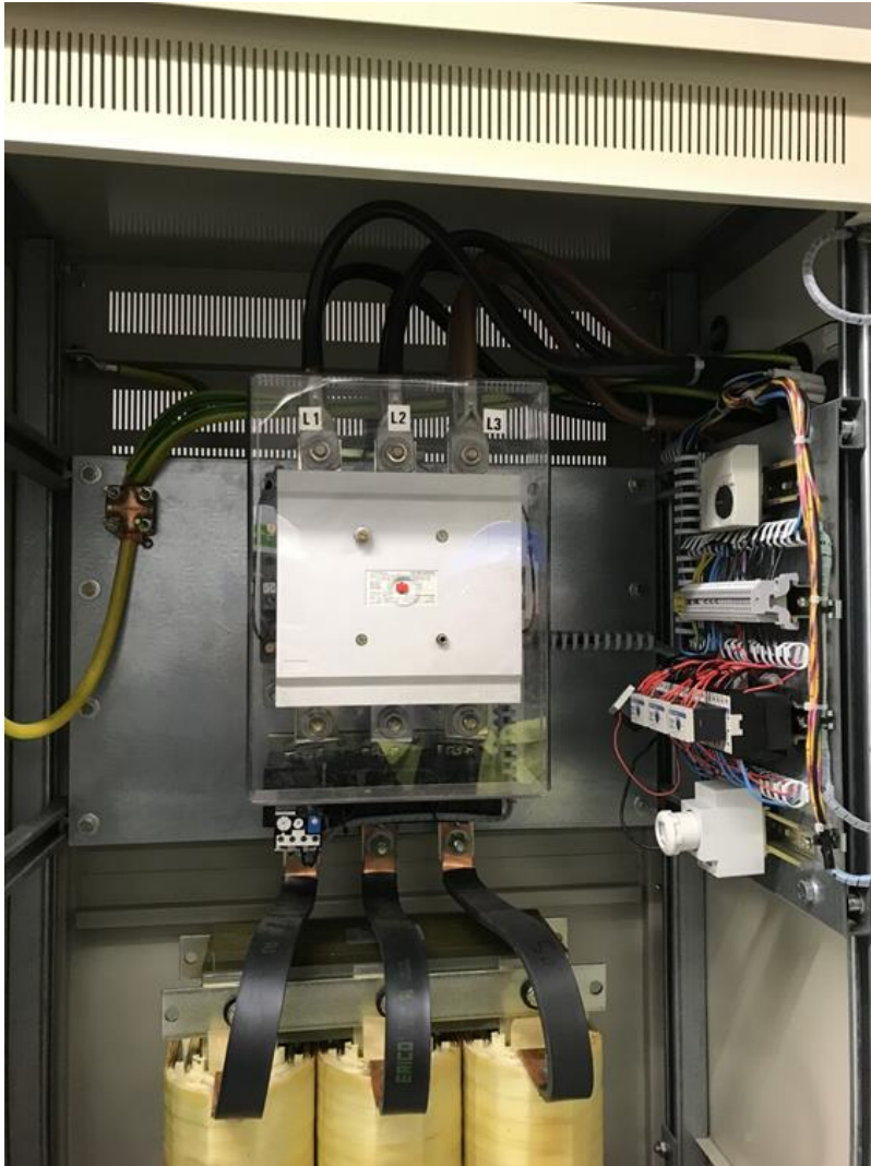
KUVA 18. Yliaaltosuodattimen kontaktori, lämpörele sekä apujännitepaneeli
