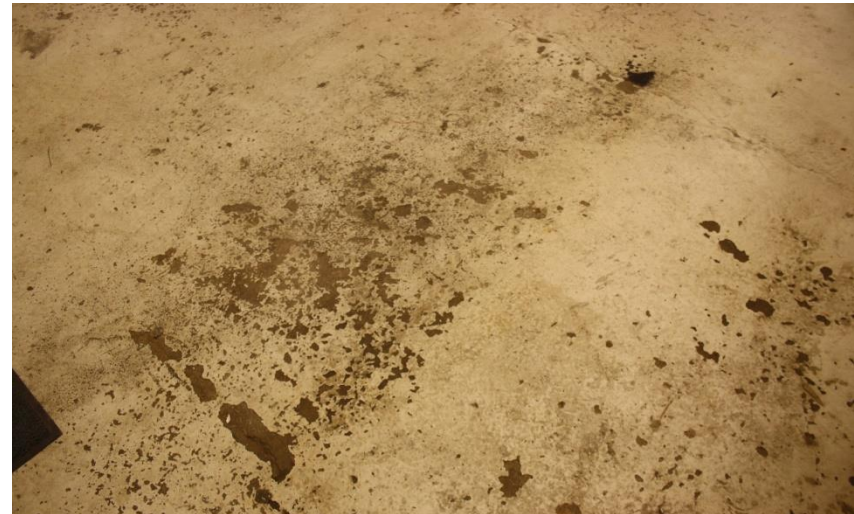
Kuva 34, Alimman kerroksen suuren tilan vaurioitunut lattiapinta.
