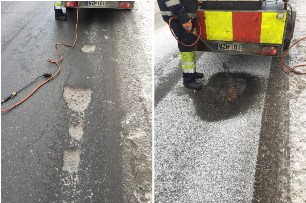
KUVA 26. Kuvat Vaasantien rei'istä (Kuva: Tommi Sulin 2018).
