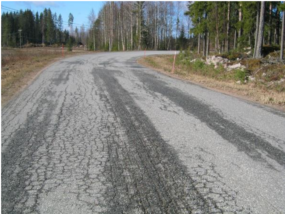
KUVA 2. Päällysteen verkkohalkeama (Kuva: Roadex network 2018)
