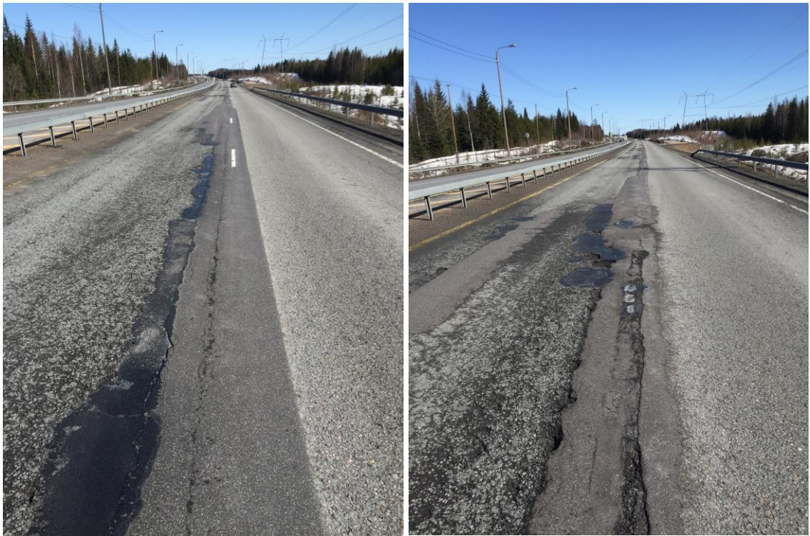
KUVA 23. Valupaikkauksien vaurioita. (Kuva: Tommi Sulin 2017).
