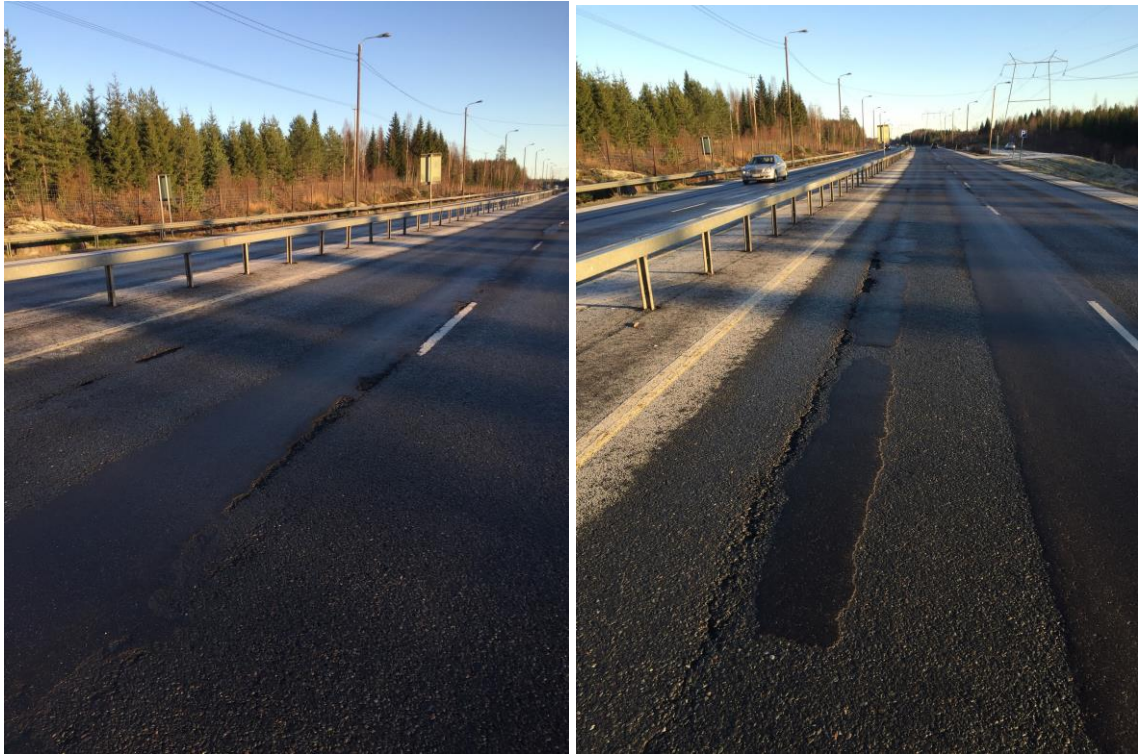
KUVA 22. Jyväskylätien halkeamia. (Kuva: Tommi Sulin 2018).
