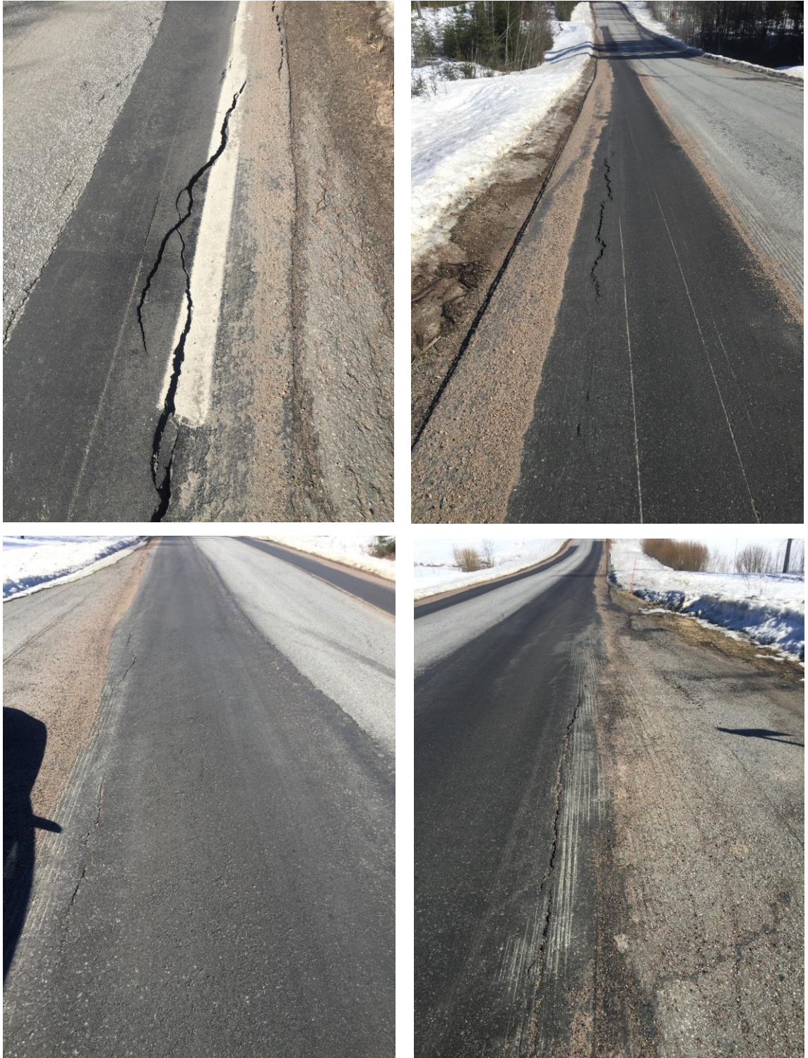
KUVA 19. Kyrönlahdentien TOPEKA- paikkausten talven aikaisista vaurioista. (Kuva: Tommi Sulin 2018).
