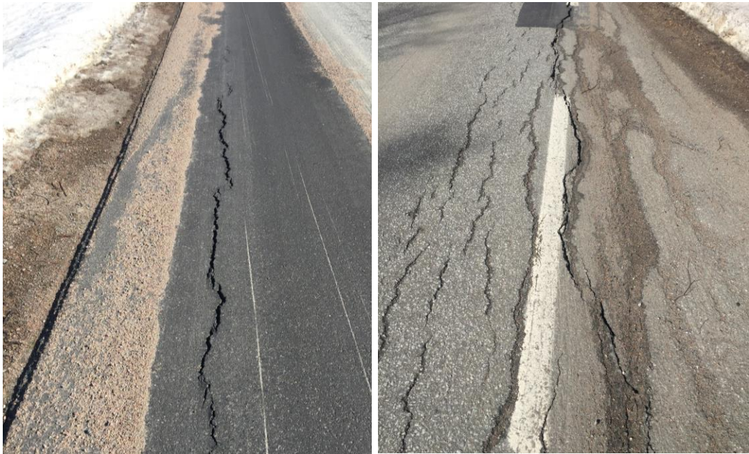
KUVA 4. Päällysteen pituussuuntainen halkeama reuna-alueella (Kuva: Tommi Sulin 2018).
