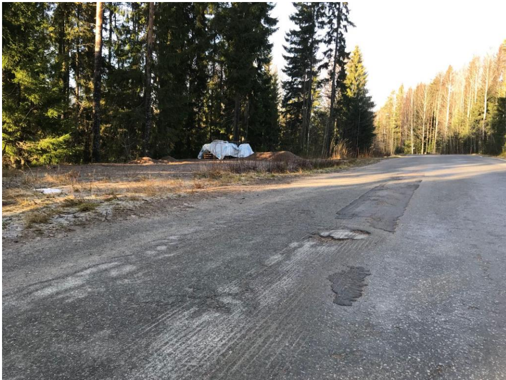
KUVA 17. Kyrönlahdentien pinnan kulumaa, reikä ja vanha päällystepaikkaus (Kuva: Tommi Sulin 2017).
