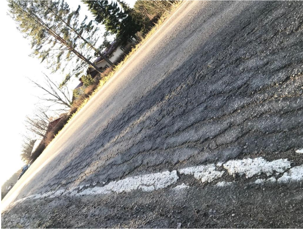
KUVA 3. Päällysteen verkkohalkeama ajoradan ulkopuolella (Kuva: Tommi Sulin 2018).
