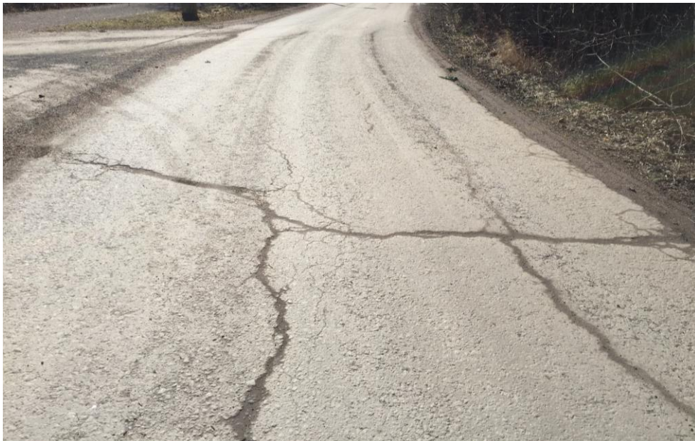
KUVA 5. Päällysteen poikkisuuntainen ja pituussuuntainen halkeama (Kuva: Tommi Sulin 2018).
