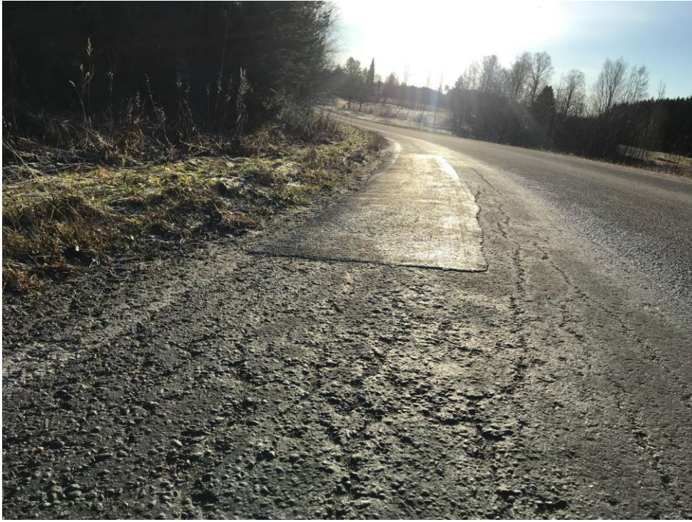
KUVA 16. Kyrönlahdentien verkkohalkeamaa ja vanha päällystepaikkaus (Kuva: Tommi Sulin 2017).
