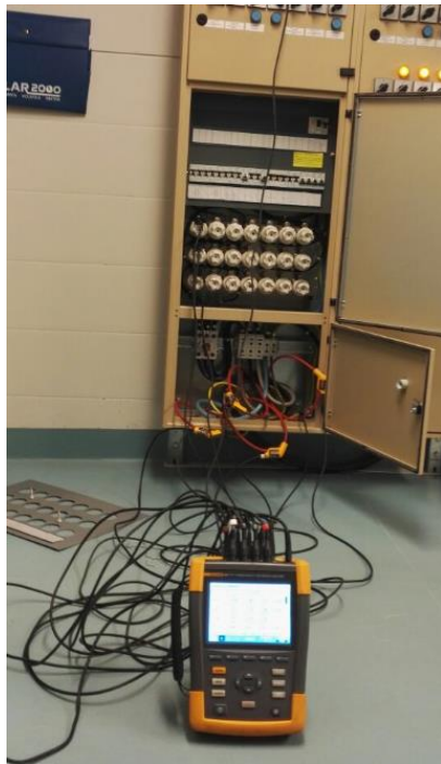
Kuva 8 Sähkönlaadun analysointilaitteita kytkettynä keskuskeskukseen
