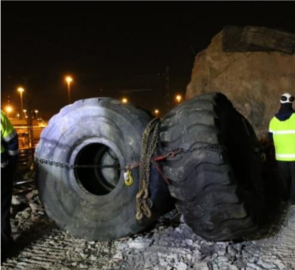
Kuva 13. Portaalipylvään jalustan suojaukseen käytettävä rengasyhdistelmä
