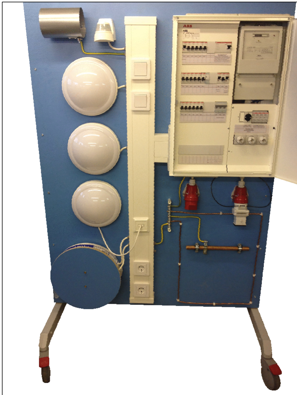
Kuva 8. Käyttöönottotarkastuksen harjoittelua varten rakennettu testiasennus
