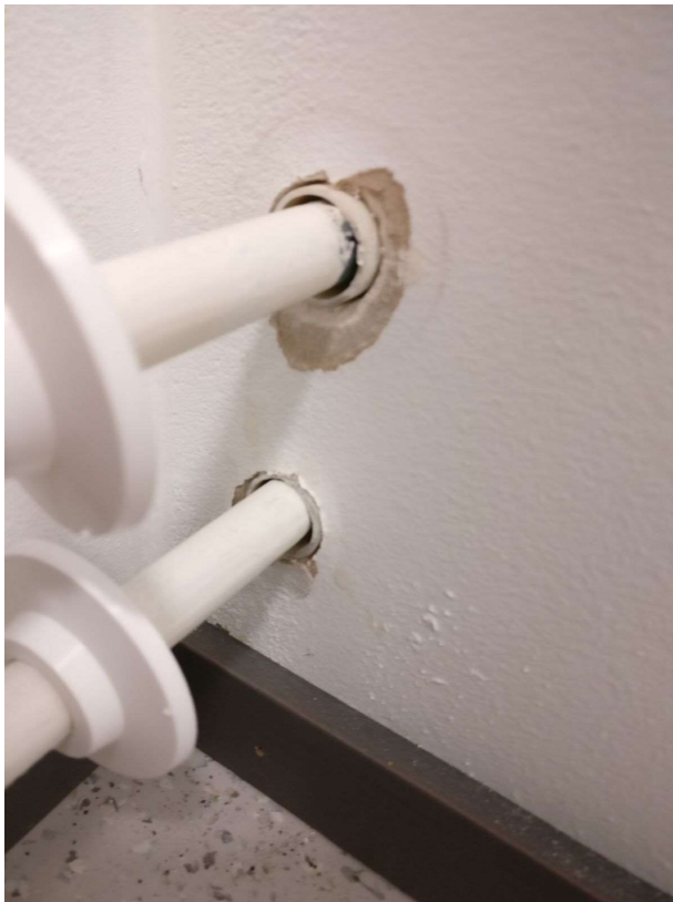
Kuva 34. Patterin lämpöputkien tiivistämätön läpivienti.
