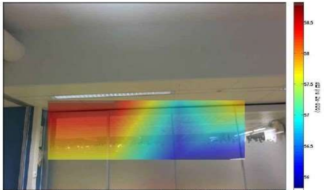
E166, etummainen lasiväliseinä vasemmalta ylhäältä. Desibelivaihteluväli: 56-68,5 dB. Seinän oikeassa ylänurkassa havaittavissa vuotoa.
