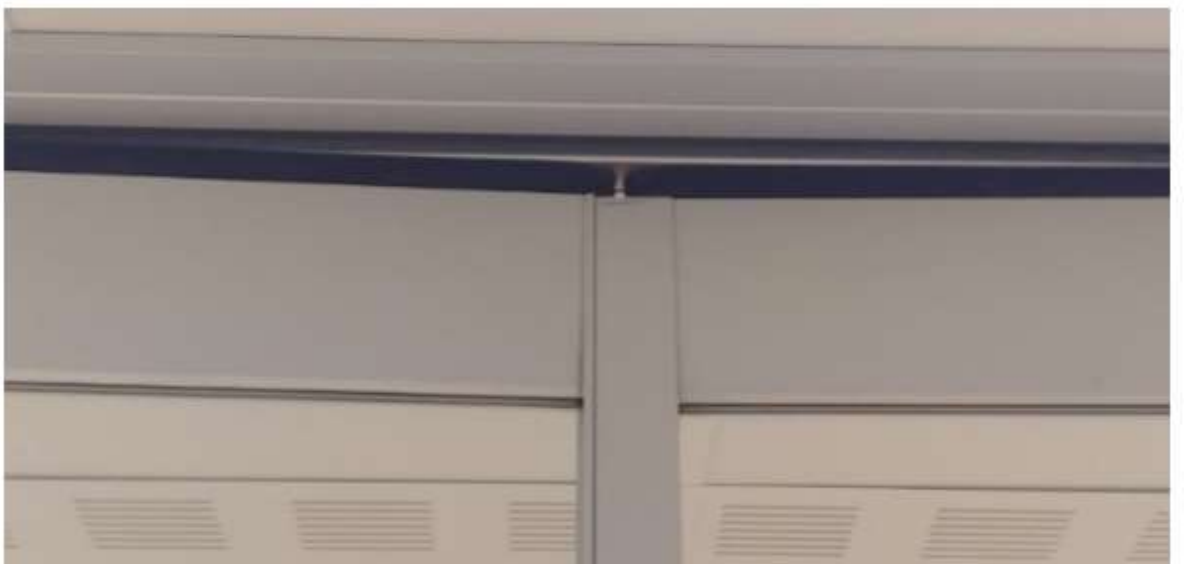
Kuva 36. Tilojen E116/E117 välisen lasiväliseinän ylätiivisteessä rako.
