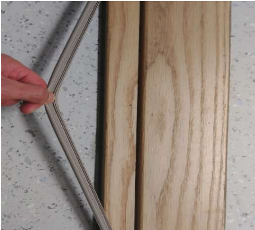
Kuva 33. Tilan D112 ovikynnyksen tiiviste on lähes kokonaan irti, eikä eristä todennäköisesti ääntä siltä odotettavalla tavalla.
