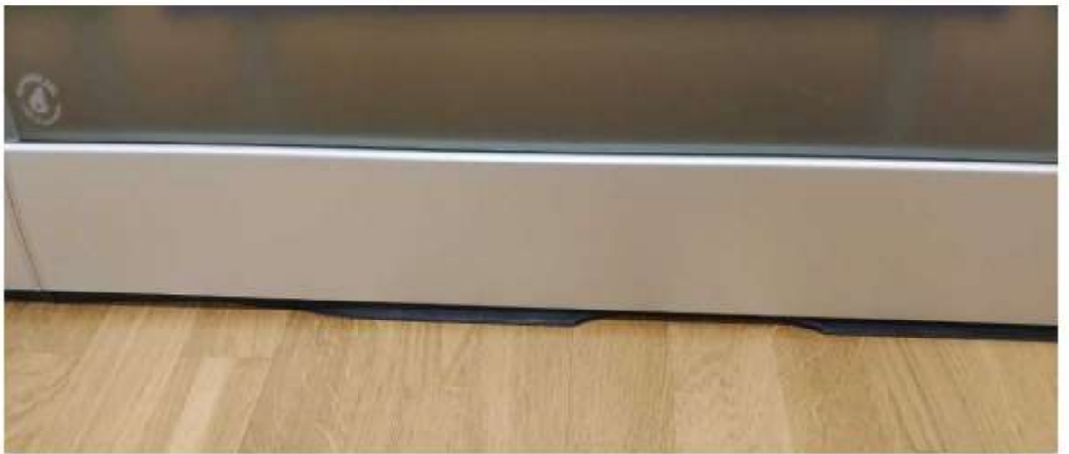
Kuva 35. Tilojen E116/E117 välisen lasiväliseinän tiiviste on mutkalla, mikä johtaa äänenvuotoon.
