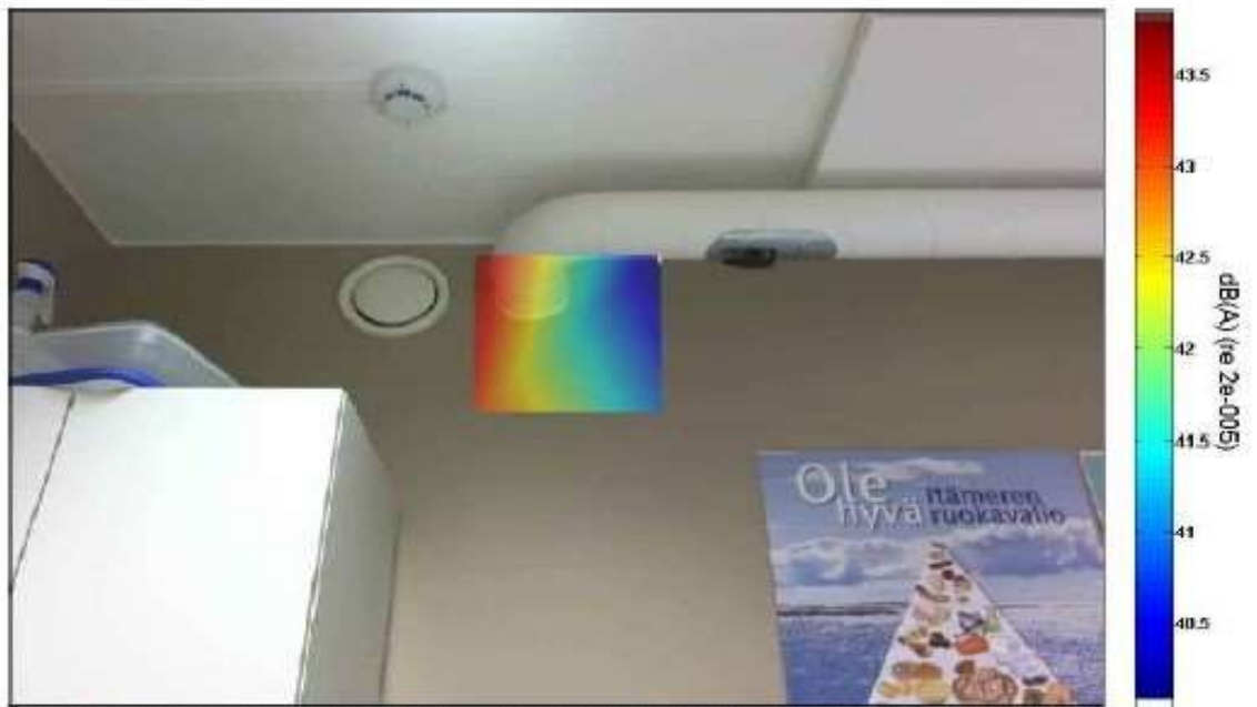
D111, IV-läpivienti. Desibelivaihteluväli: 40,5-43,5 dB. Havaittu vaihtelu johtuu todennäköisesti viereisen päätelaitteen tuottamasta äänestä, eikä niinkään läpiviennin vuodosta.
