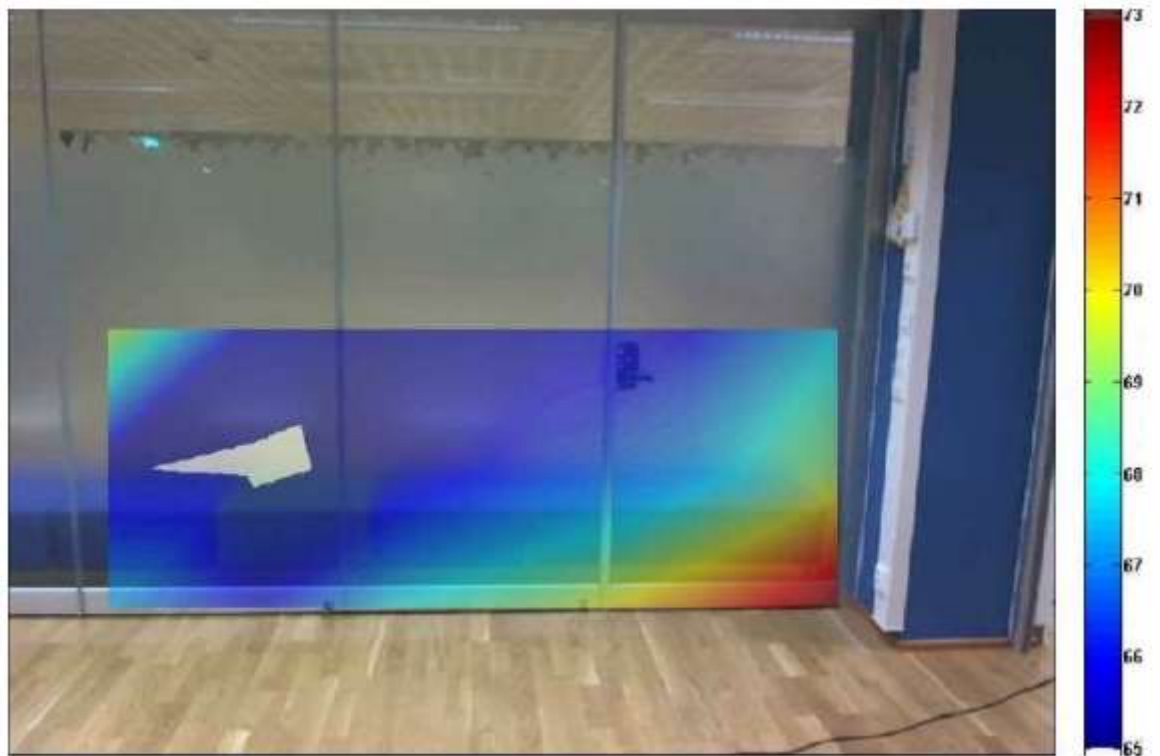
Kuva 29. E-talon liukuväliseinä vuotaa oven alanurkasta.
