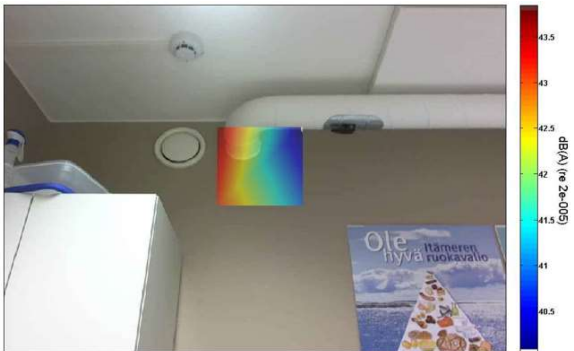
Kuva 21. Tilan D111 IV-läpivienti, jossa vieressä poistupuolen päätelaite (liite 1).
