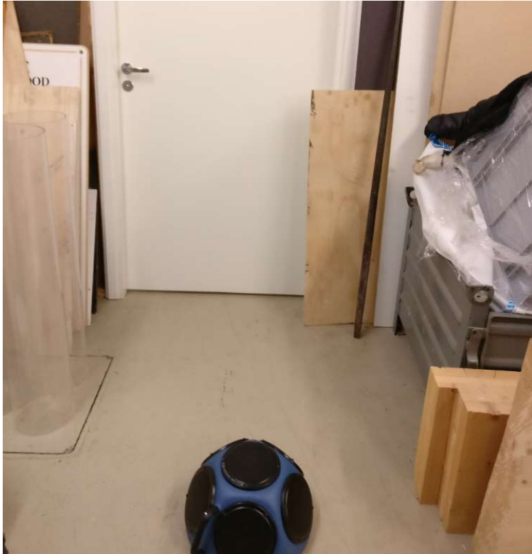
Kuva 15. Havainnekuva äänilähteestä rakenteen vuotokohtakartoituksessa.
