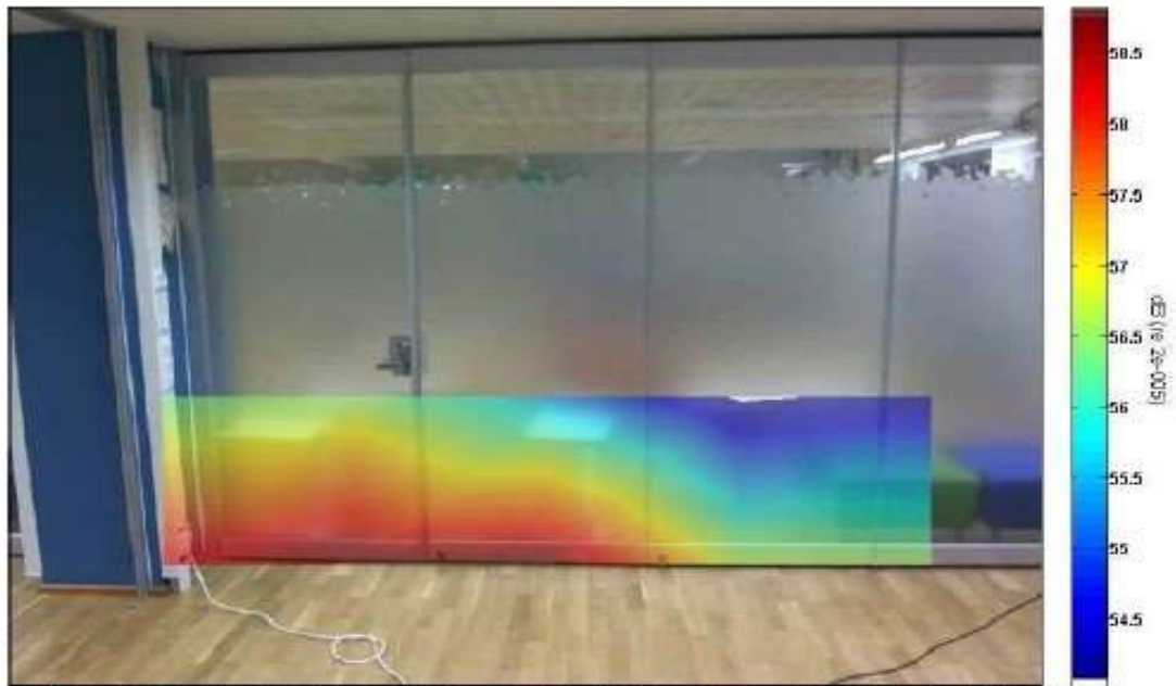
E166, etummainen lasiväliseinä vasemmalta alhaalta. Desibelivaihteluväli: 54,5-58,5 dB. Seinän alareunassa havaittavissa vuotoa.
