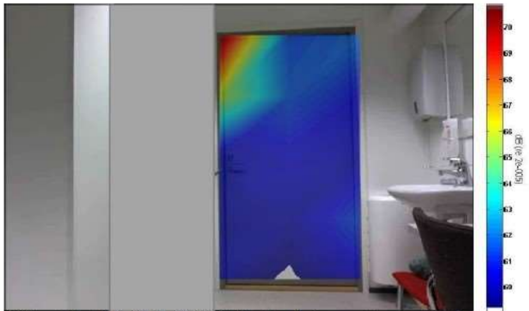
D112, ovi. Desibelivaihteluväli: 60-70 dB. Oven kahvanpuoleisessa ylänurkassa havaittavissa selkeää vuotoa.
