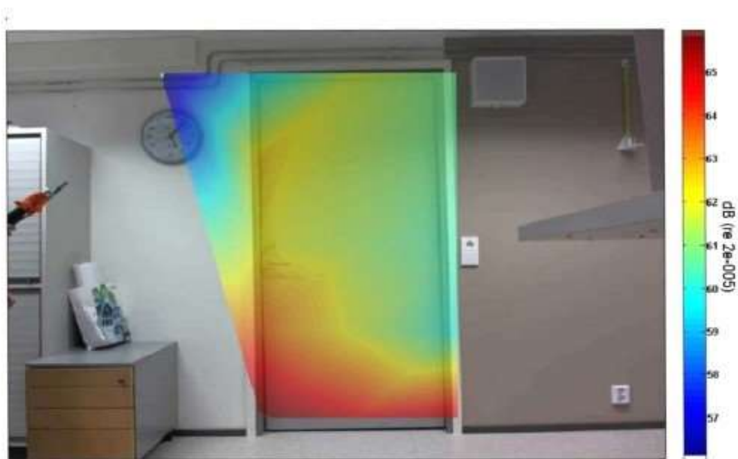
D111, ovi. Desibelivaihteluvali: 57-65 dB. Oven alareuna vuotaa reilusti.
