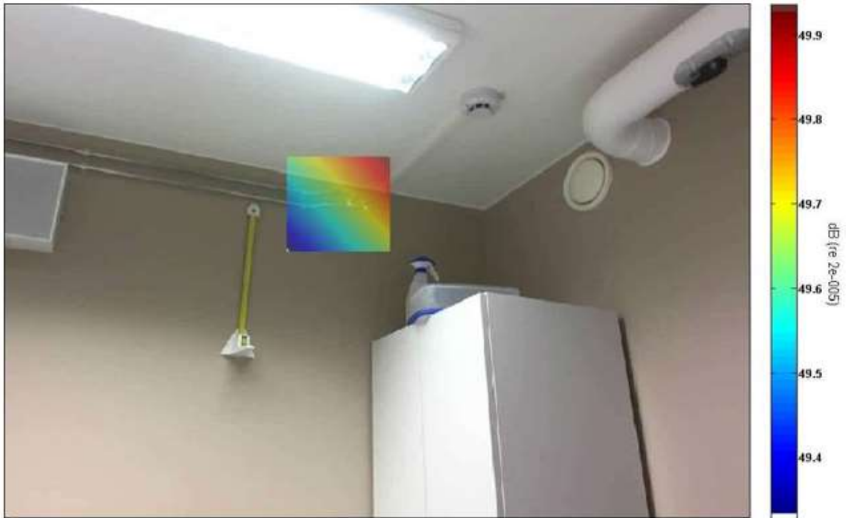
Kuva 20. Tilan D111 Vesijohtojen läpivienti (liite 1).
