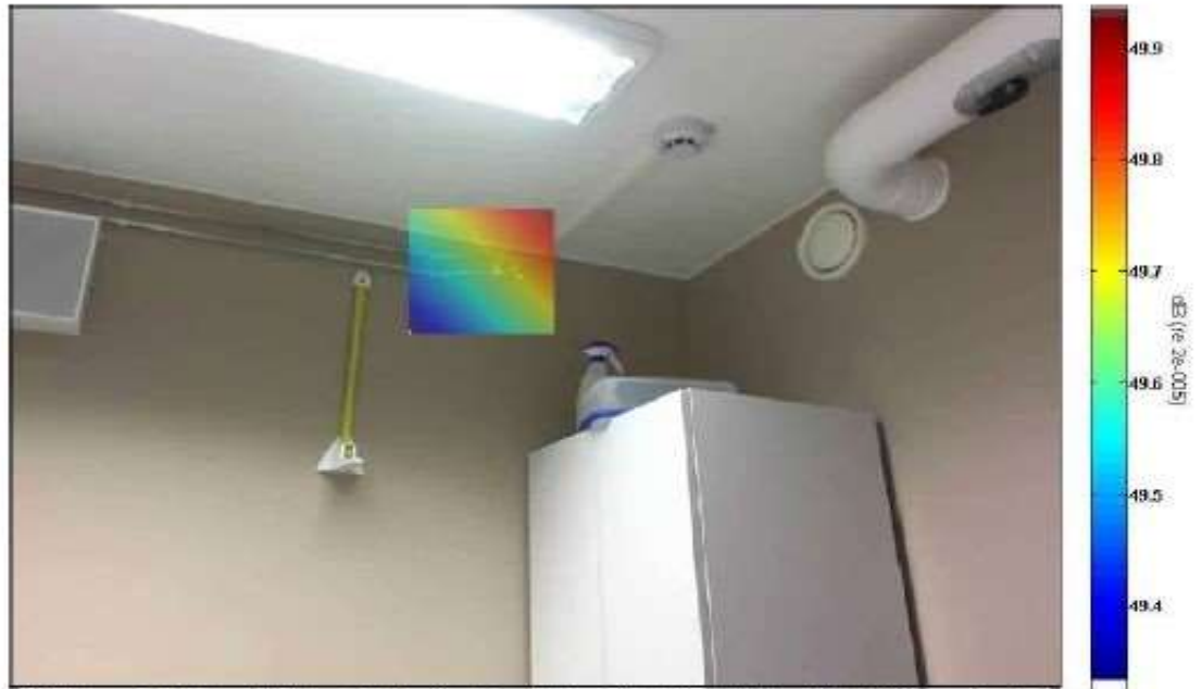
D111, vesijohdon läpivienti. Desibelivaihteluväli: 49,4-49,9 dB. Läpiviennistä voidaan havaita vuotoa, jolla ei käytännössä ole kuitenkaan vaikutusta tilan äänitekniisiin ongelmiin.
