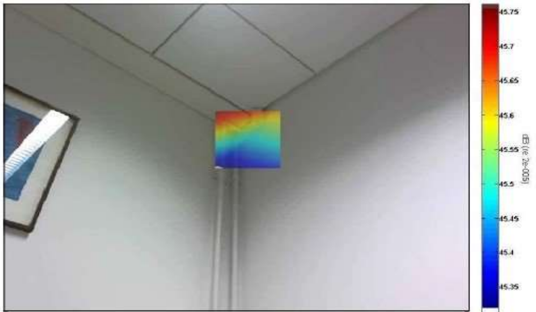
D115, lämpölinjan läpivienti. Desibelivaihteluväli: 45,35-45,75 dB. Läpiviennissä havaittavissa merkityksettömän pientä vuotoa.
