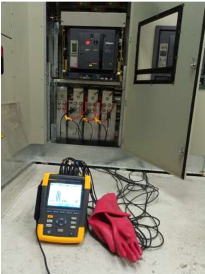
KUVA 2. Sähköanalysaattori kytkettynä pääkeskukseen.
