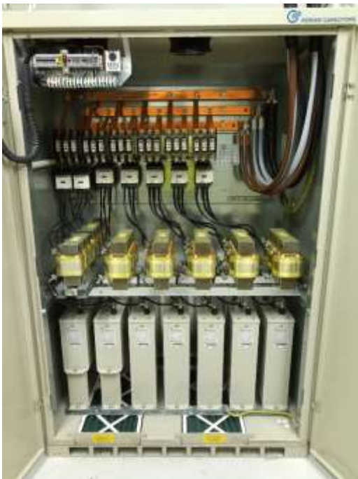
KUVA 1. Estokelapariston kytkentä sisältäpäin.
