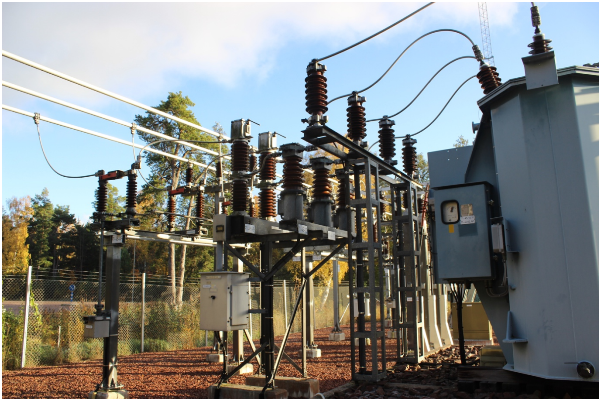
Figur 2 Ställverket i Lervik Ytternäs
