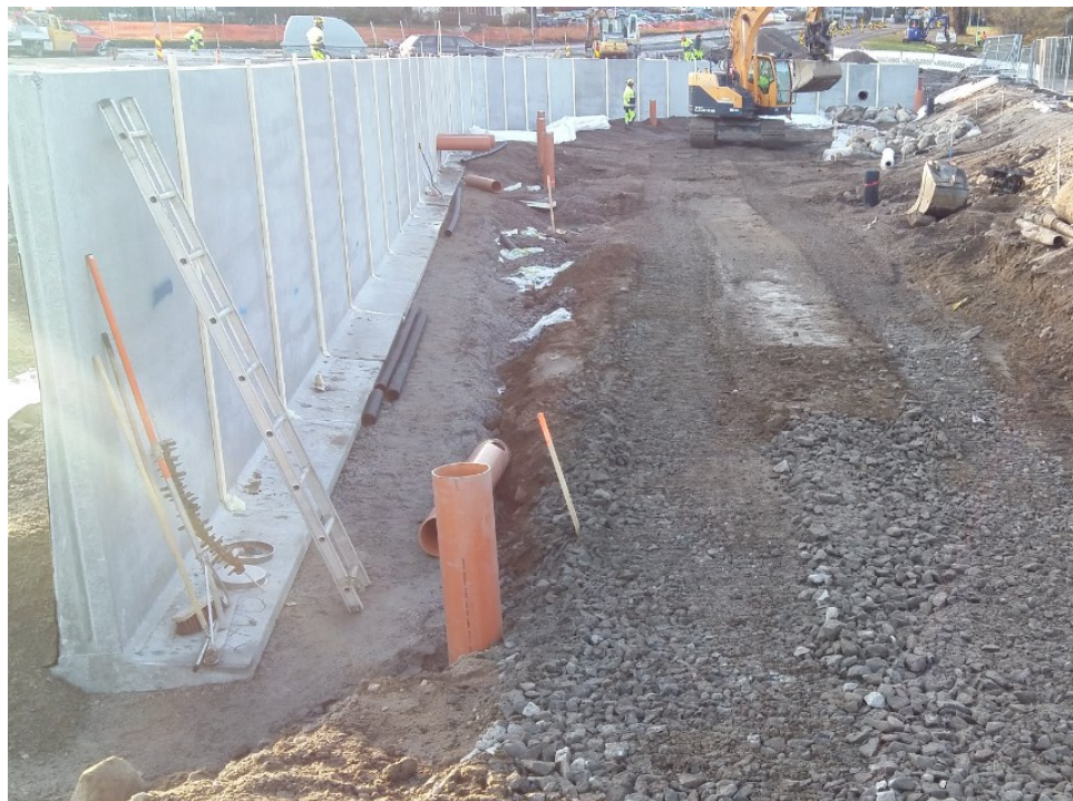
Kuva 33. Tukimuurin elementit on asennettu. Takana oikealla toisessa tukimurielementissä näkyy ylivuotoputken pää ja vasemmalla näkyy purkuputket, joita pitkin vesi johdetaan biopidätysaltaaseen nyt aluksi yhtä putkea pitkin väliaikaisesta hulevesialtaasta, mutta tulevaisuudessa kaikkia kolmea putkea pitkin myöhemmin rakennettavasta hulevesialtaasta. Altaan pohjalla näkyy monessa kohtaa jo asennetun salaojaputkiverkoston tarkastuskaivoja. (Ojansuu 2017.)
