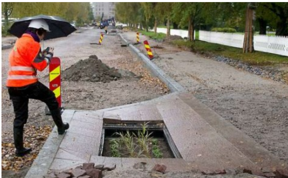
Kuva 43. Rain Gardenin on asennettu ja reunustettu graniitti laatoilla. Kaikki suodatin kerrokset on asennettu ja kasvit istutettu. Kuvasta näkyy hyvin, miten reunakivi altaan edessä on madallettu, jotta vesi pääsee virtaamaan altaaseen. Laatikon takareunassa näkyy koko laatikon levyinen ritilä, josta vesi virtaa sisään sakkapesään, jossa hiekka ja muut isommat partikkelit jäävät sakkapesän pohjalle ja vesi tulvii kasvukerroksen päälle, jossa kasvit kasvavat. (Hussain 2017.)
