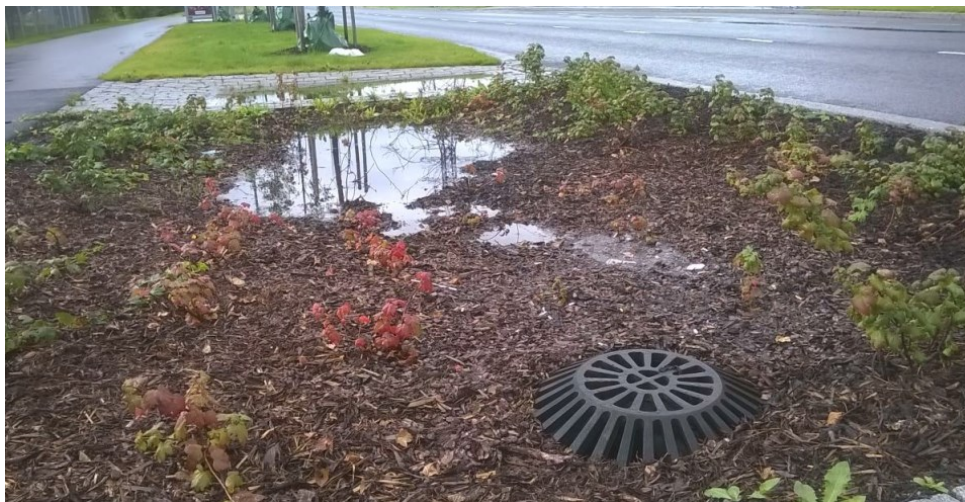
Kuva 9. Meirantien biosuodatusalueen tulvimista varten on painanteen perälle sijoitettu ylivuotokaivo, jossa on kupukansisto (Jormola 2015, 10).
