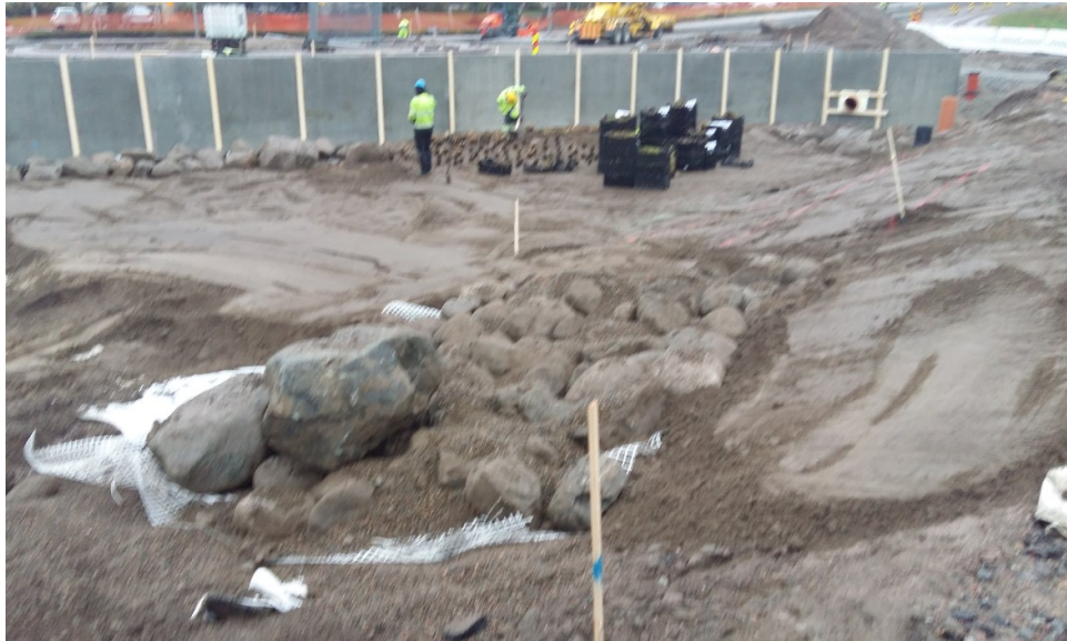
Kuva 34. Biopidätysaltaan pohjan muoto alkaa hahmottua ja sinne ollaan istumassa suunnitelman mukaisia kasveja ja pensaita. Edessä näkyy pyöreistä luonnonkivistä tehty alue. Kivien alle laitettiin geoverkko, jottei kivet painu niiden alla olevaan salaojasoraan. (Ojansuu 2017.)
