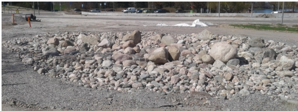
Kuva 37. Väliaikainen hulevesiallas valmiina. Kivien keskellä on ritiläkaivo, josta vesi pääsee virtaamaan putkea pitkin kuvassa takana näkyvään biopidätysaltaaseen. (Siilin 2018.)
