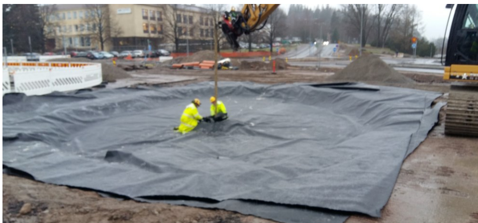
Kuva 35. Väliaikaisen hulevesialtaan pohjalle on asennettu vettä pitävä PE-kalvo ja altaan keskellä olevan ritiläkaivon kansistoa asennetaan oikeaan korkoon (Ojansuu 2017).
