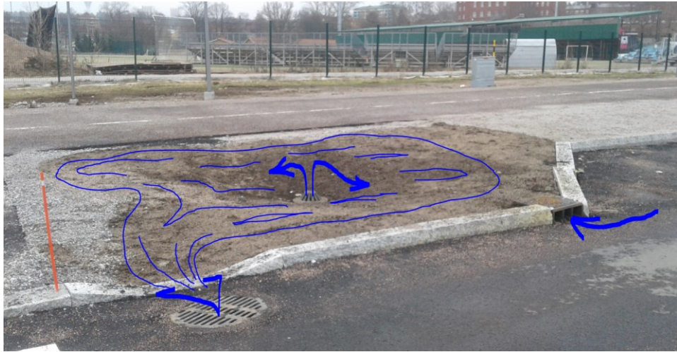
Kuva 27. Edellisen kuvan hulevesitasku valmiina. Kuvaan piirretty sinisellä periaate veden kulusta taskun läpi tilanteessa, jolloin kaikki tasukuun virtaava vesi ei ehdi imeytää suodatuserrosten läpi salaoja-putkistoon. Kitakaivoa edeltävä reunakivi on liikahtanut heti ensimmäisen talven aurausten yhteydessä. (Siilin 2018.)
