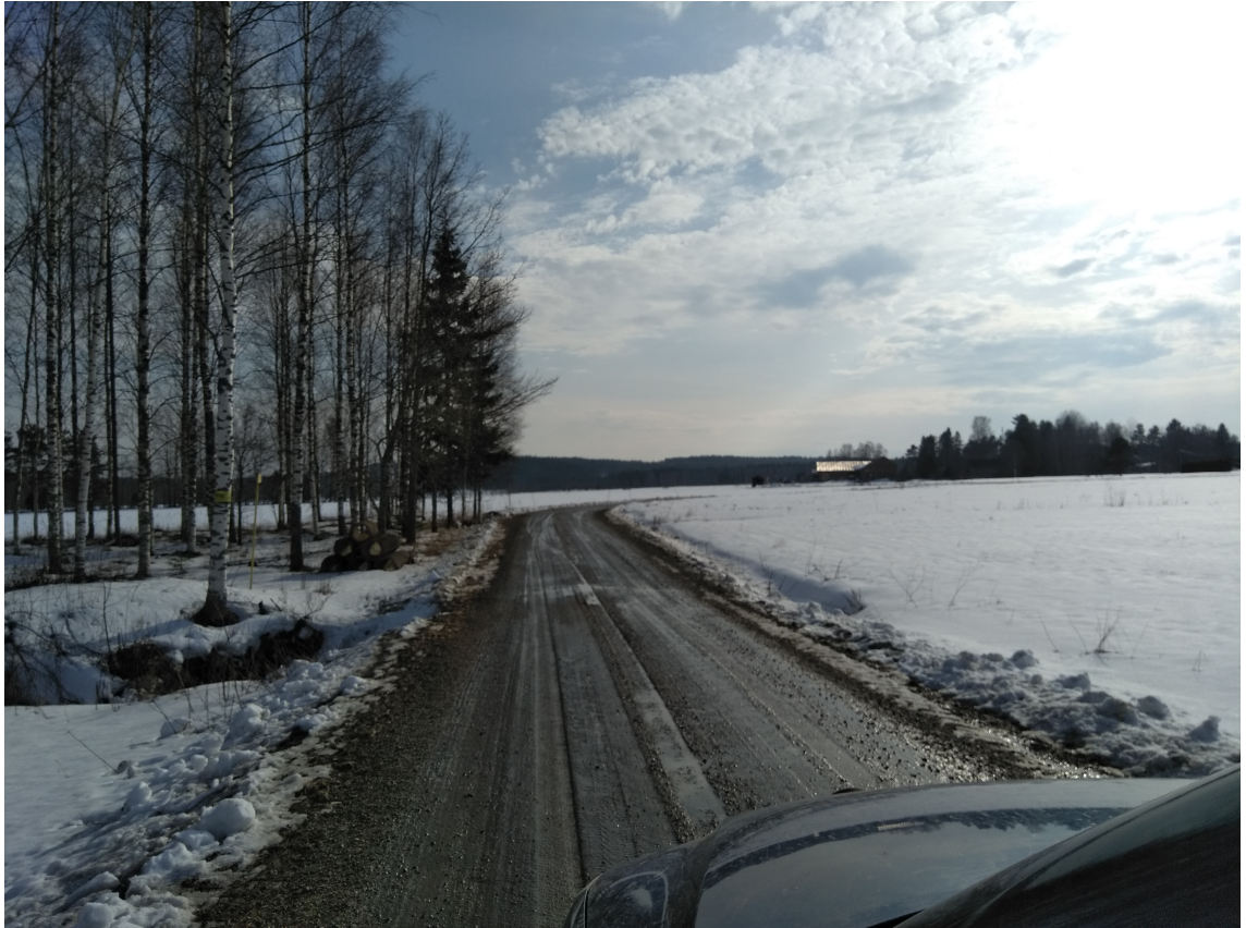
Kuva 1. Pintakelirikko alkamassa ja rummun kohdalla painuma (Ville Ahvonen 2018)
