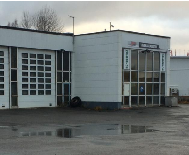
Kuva 6. Sadevedet lammikoituvat piha-alueella.
