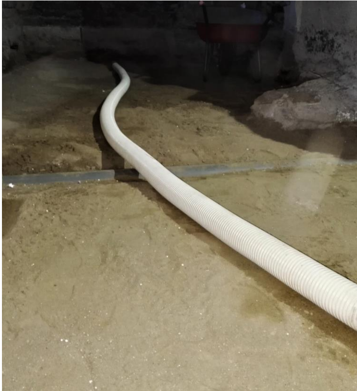
KUVA 25. Vanhan alapohjan alla ollut radonputki.
