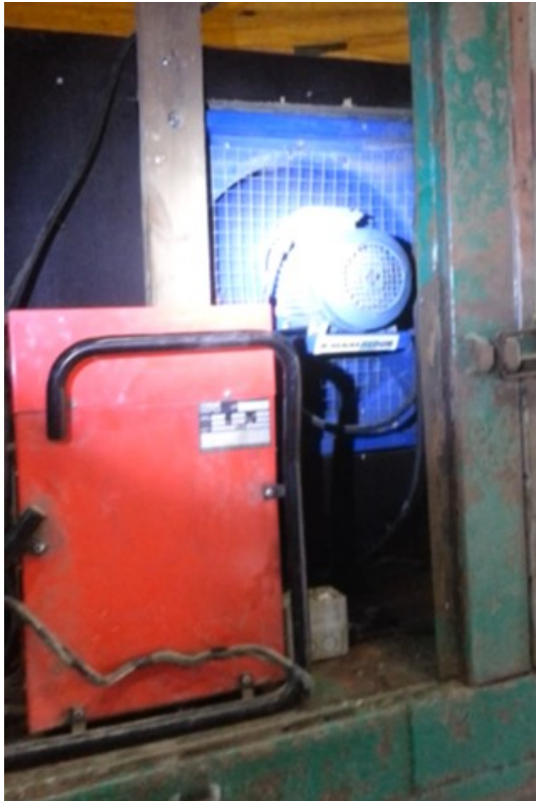
Kuva 31. Puhaltimen eteen sijoitettiin lämmitin. (Kause 2017)
