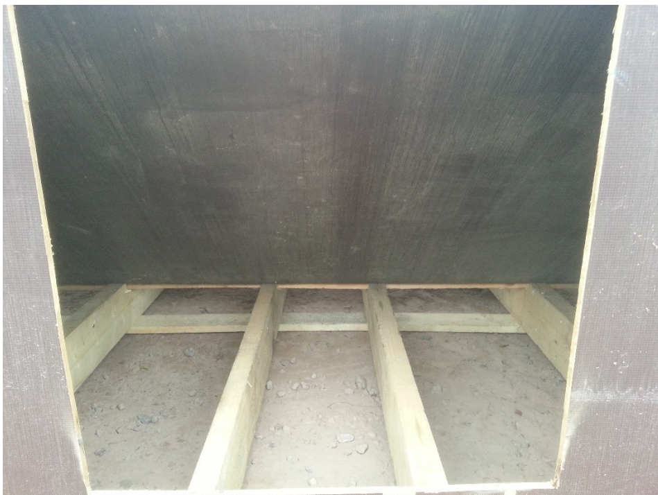
Kuva 29. Ilmakeanavat näkyvät puhallinaukosta. (Kause 2017)
