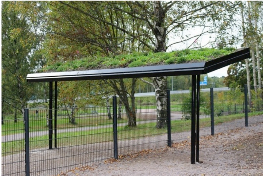
Kuva 11. Kesällä asennettu viherkatto vihersi syksyllä (Lemola R. 2017).
