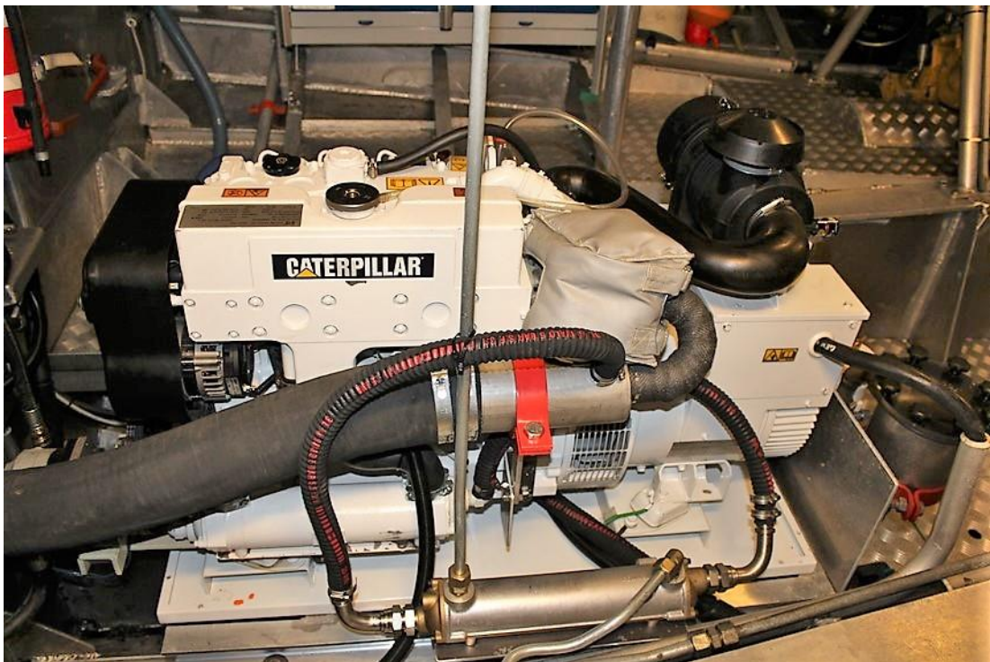
Kuva 9. Apukoneen yleiskuva kyljestä.
