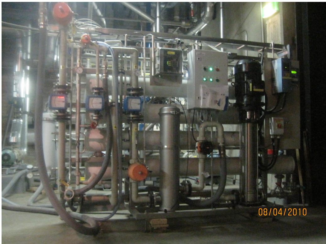
Kuva 2. Käänteisosmoosilaitteisto Martinlaakson voimalaitoksella.
