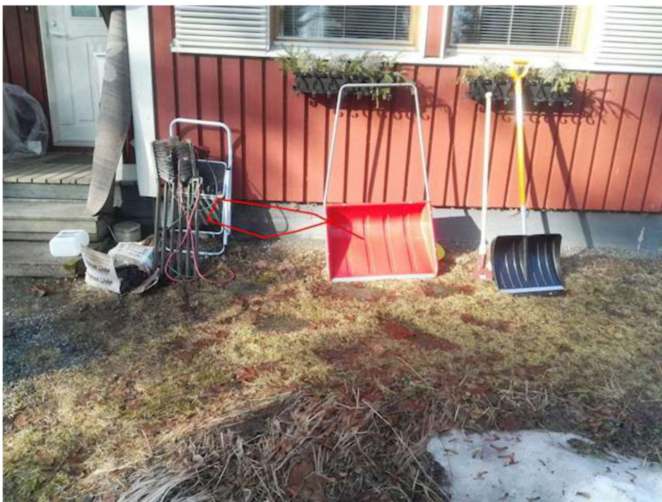
(Kuva 3.) Sokkelin kastunut alue keittiön kohdalla.
