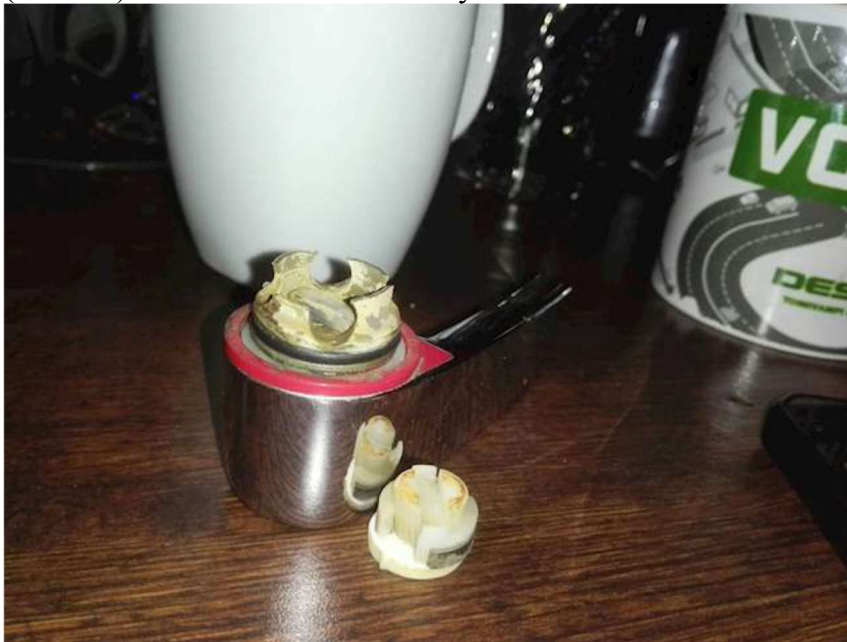
(Kuva 1.) Keittiön altaan kuuma käyttöveden kahva irronnut
