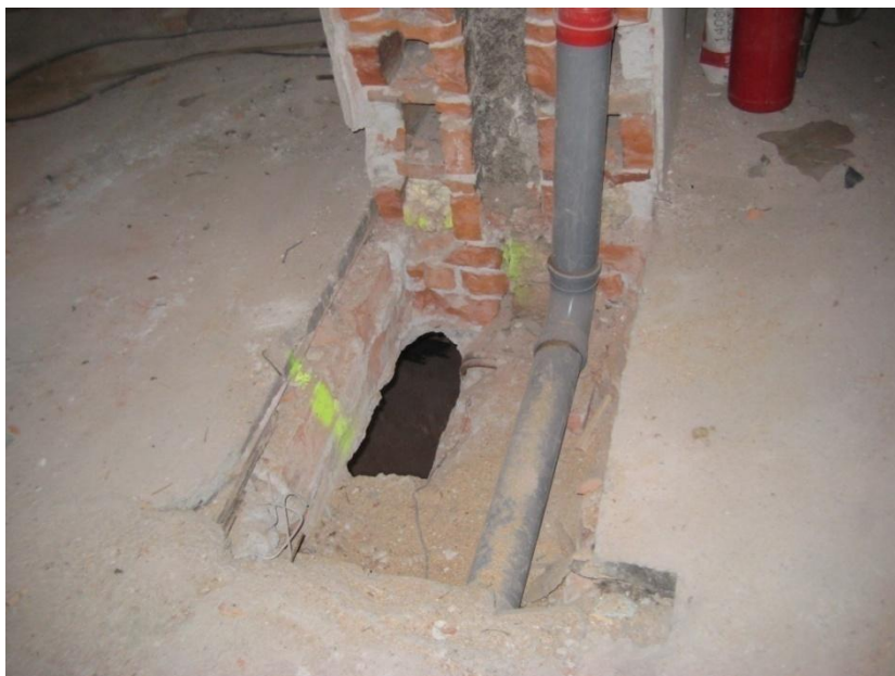
Kuvio 3. Kaikki aukot, joihin tavarat ja henkilöt saattavat pudota, on suojattava jalkalistallisilla kaiteilla tai suljettava suojakansilla.
